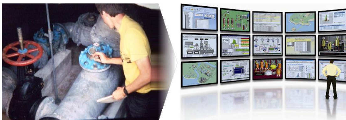
Εικόνα 4 Αυτοματοποίηση μονάδας αφαλάτωσης
