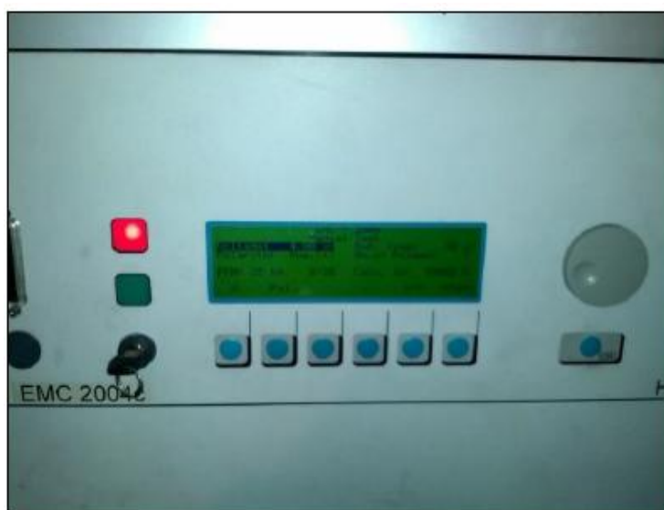
Εικόνα 4.7: Ρύθμιση τάσης φόρτισης της γεννήτριας υπό τάση [3]
