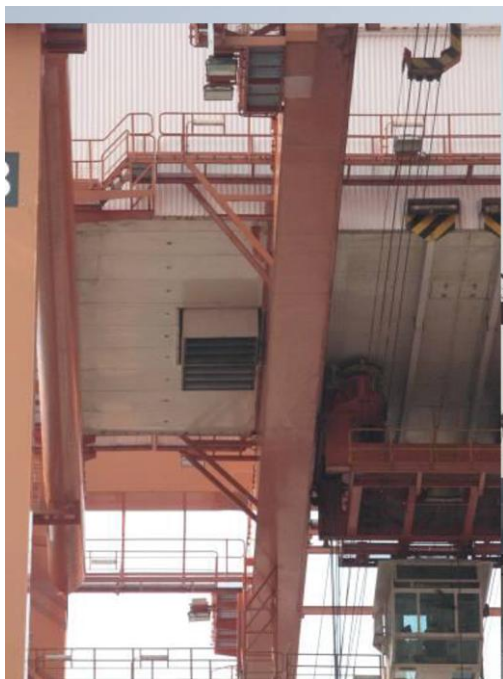
Εικόνα: Μονωμένη έξοδος εξαερισμού σε γερανογέφυρα
