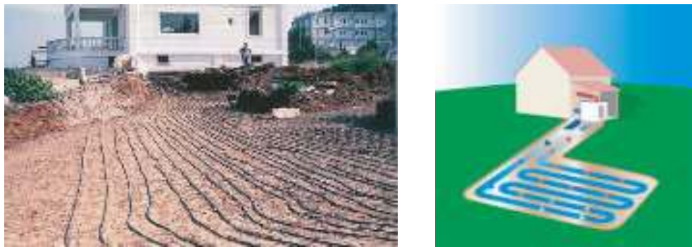
Εικόνα 5.6: Εγκατάσταση Γ.Α.Θ. με οριζόντιους Γ.Ε.Θ
