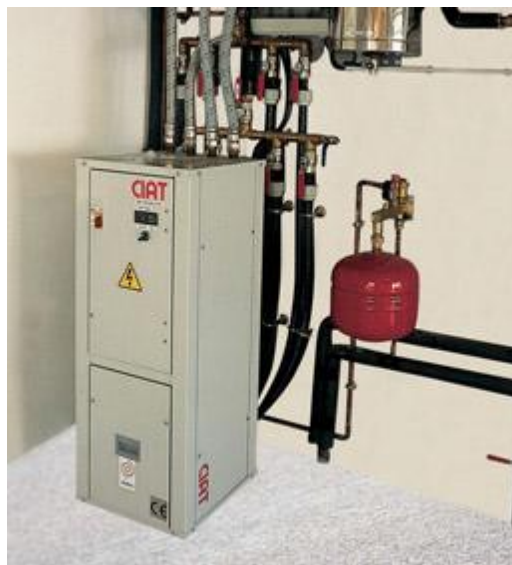
Εικόνα 5.9: Γεωθερμική Αντλία Θερμότητας
