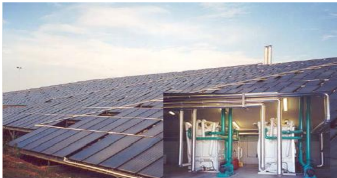
Εικόνα 5.5: Εφαρμογές ηλιακού κλιματισμού στην Ελλάδα. Πεδίο επίπεδων ηλιακών συλλεκτών και δύο ηλιακοί ψύκτες (πρόσφυσης) για τον κλιματισμό των αποθηκευτικών χώρων για τα προϊόντα της βιομηχανίας καλλυντικών Σαράντης στην Βοιωτία[24]
