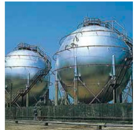
Κρυογενική μόνωση εν κενώ αέρος Δεξαμενές φυσικού αερίου
