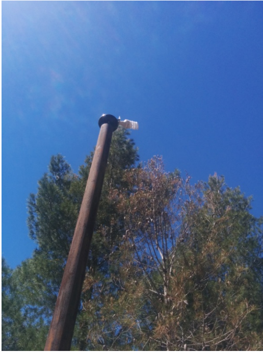
Σχήμα 18 - Φωτιστικό με έλλειψη καλύμματος και χαλασμένο λαμπτήρα
