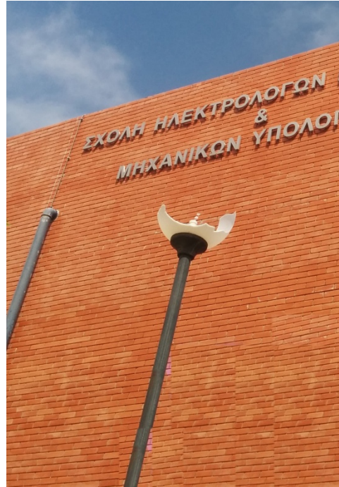
Σχήμα 19 - Φωτιστικό με σπασμένο λαμπτήρα και κάλυμμα
