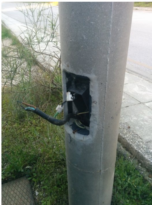
Σχήμα 20 - Φωτιστικό χωρίς πλήρες σύστημα λειτουργίας
