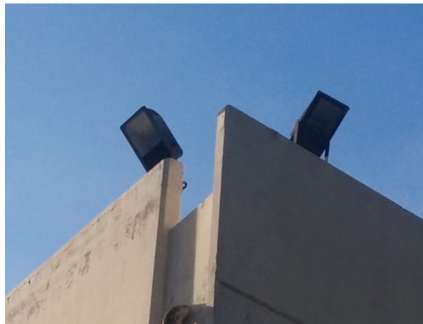
Σχήμα 3 – Προβολείς σε κτίριο του Ε.Μ.Π.
