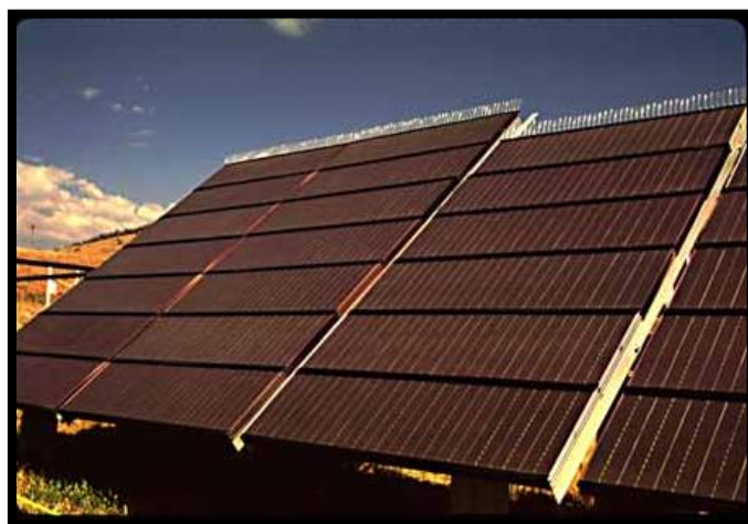
Εικόνα 3.13: Φωτοβολταϊκό πάρκο με πανέλα καδμίου-τελλουρίου Πηγή: http://ee.utep.edu/ [37]
