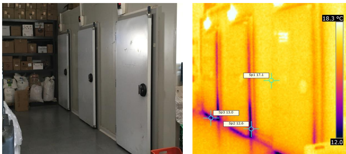
Εικόνα 3.20: Ψυγείο εγκατάστασης (walk in ψυκτικός θάλαμος)
