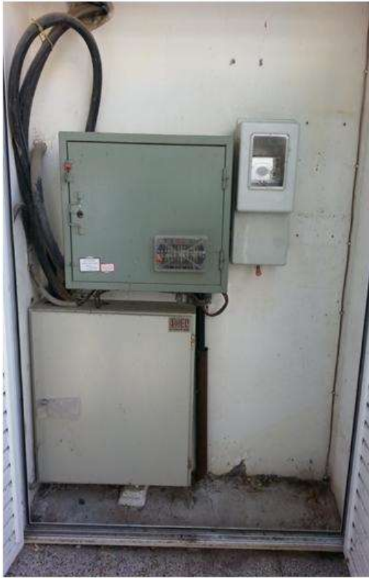
Εικόνα 4.24α: Ηλεκτρικός πίνακας του συγκροτήματος
