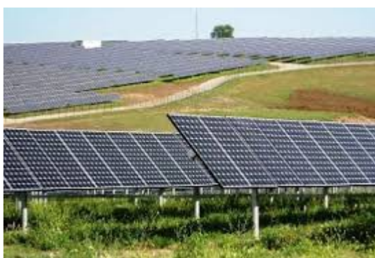
25. Εικόνα : Φωτοβολταϊκό πάρκο
