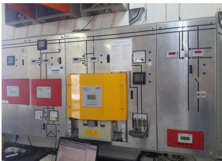
Εικόνα 4.3 Μικροδίκτυο Εργαστηρίου Συστημάτων Ηλεκτρικής Ενέργειας
