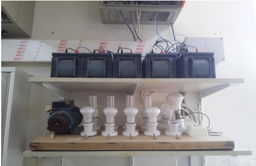
Εικόνα 4.4 Ελεγχόμενα φορτία στο εργαστήριο Συστημάτων Ηλεκτρικής Ενέργειας
