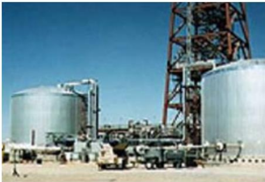
Εικόνα 2.1: Φωτογραφία του άμεσου συστήματος δύο δεξαμενών για αποθήκευση θερμότητας με χρήση τηγμένων αλάτων στις εγκαταστάσεις του Solar Two
