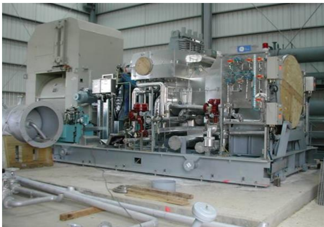
Εικόνα 5.5: Φωτογραφία της τουρμπίνας ατμού που χρησιμοποιεί ο PS10
