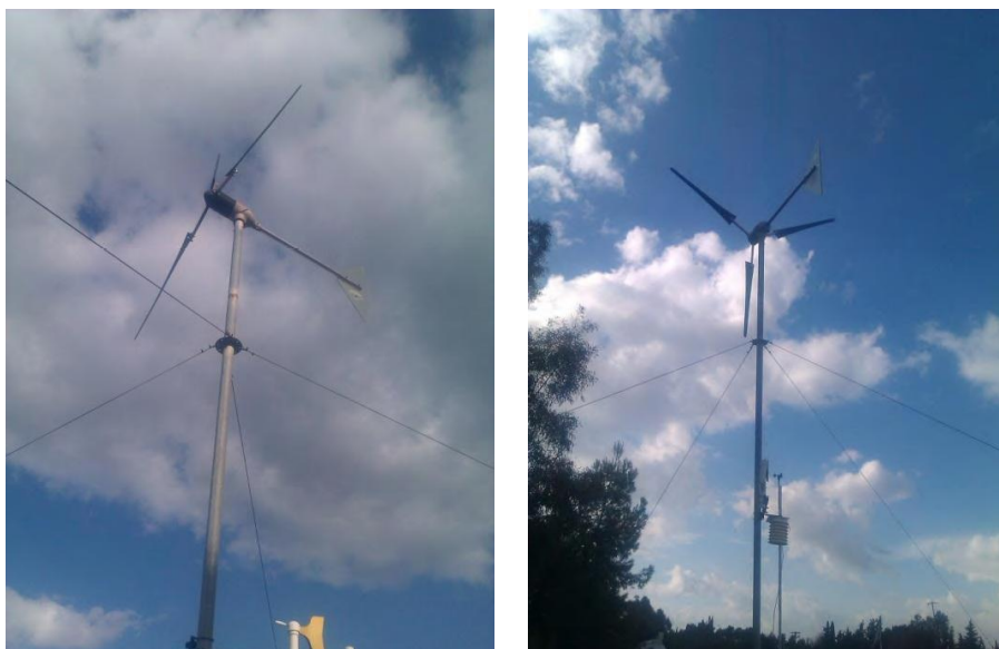
Σχήμα 2.2: Ανεμογεννήτρια εγκατεστημένη στην οροφή του Εργαστηρίου Ηλεκτρομηχανικής Μετατροπής Ενέργειας: α) Άποψη του ανεμοδείκτη, β) Άποψη του ανεμομέτρου και υγρομέτρου
