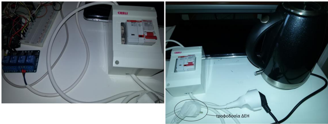
Εικόνα 63: Η σύνδεση του Arduino με τον πίνακα προστασίας και το βραστήρα
