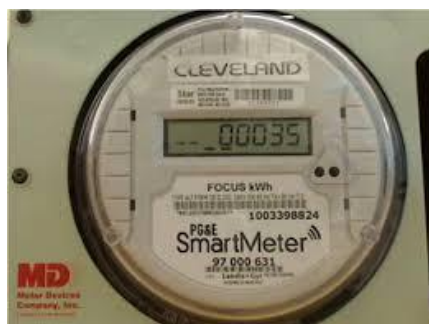
Εικόνα 9: Ηλεκτρικός έξυπνος μετρητής
