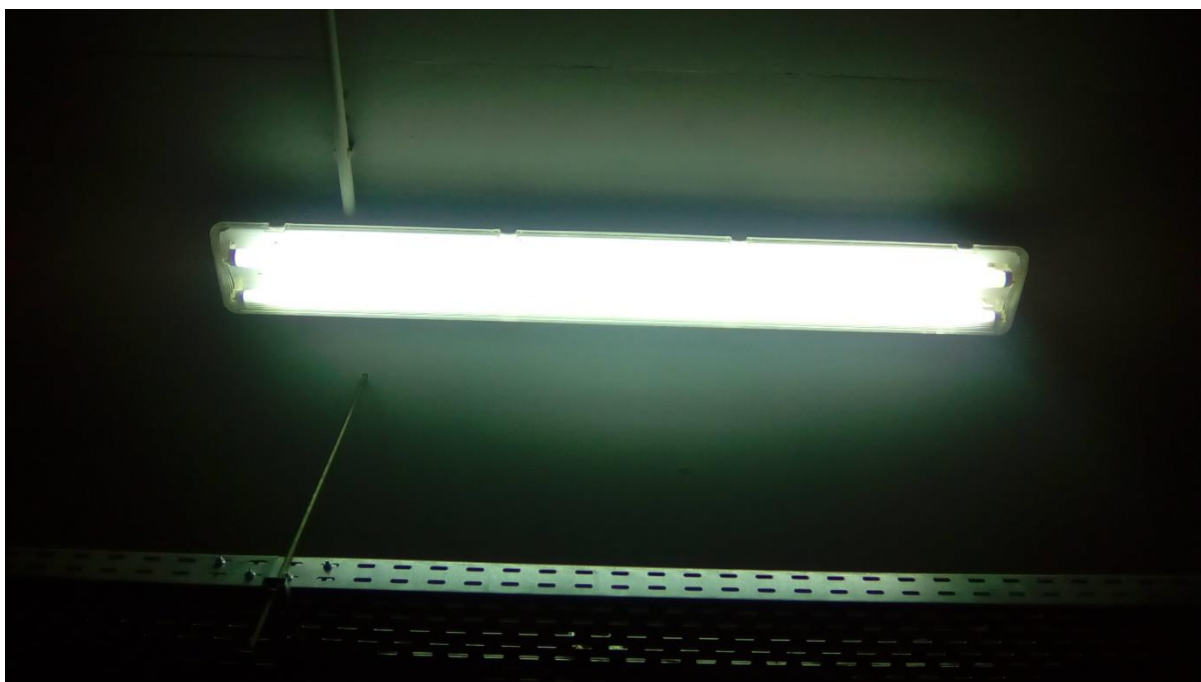
Εικόνα 7: Φωτιστικό φθορισμού, με 2 λαμπτήρες των 36 Watt, υπόγειος χώρος στάθμευσης
