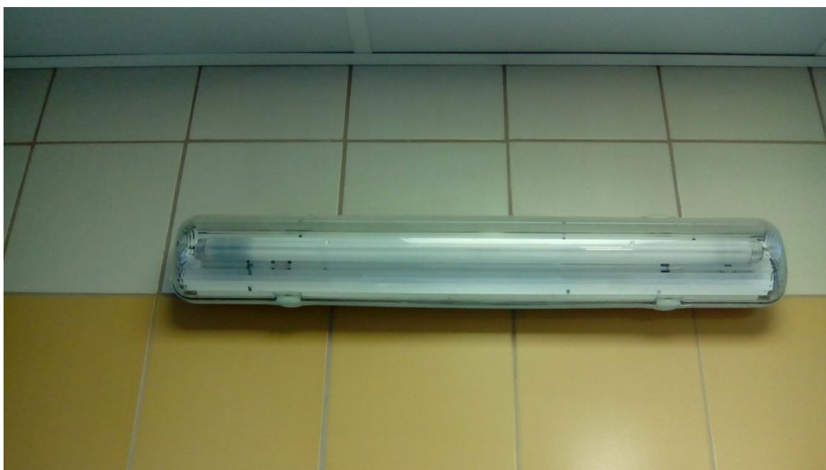
Εικόνα 8: Φωτιστικό τοίχου, με 1 λαμπτήρα των 10 watt, χώρος υγιεινής
