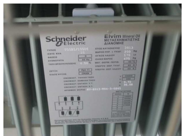
Φωτογραφία. 10: Πινακίδα Μετασχηματιστή ιδιοκαταναλώσεων
