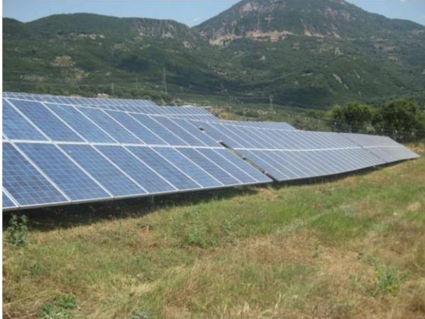
Φωτογραφία 1: Γενική άποψη
