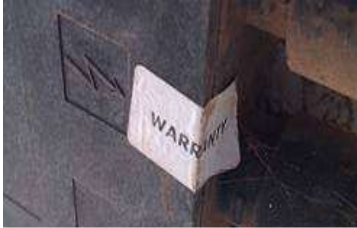
Εικόνα 54 Ετικέτα εγγύησης που σφραγίζει το κουτί συνδέσεων ενός φωτοβολταϊκού πλαισίου. [60]
