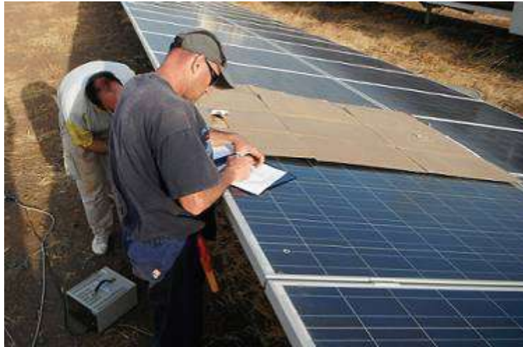
Εικόνα 56 Στην εικόνα μπορούμε να δούμε ένα καλυμμένο με χαρτόνι φωτοβολταϊκό πλαίσιο το οποίο είναι πολωμένο με μία πηγή ρεύματος (κάτω αριστερή γωνία). [60]
