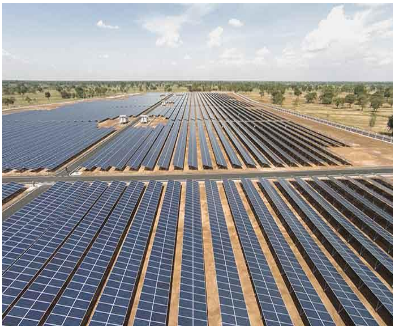
Εικόνα 1.1 : Εγκατεστημένοι συλλέκτες ηλιακής ενέργειας
