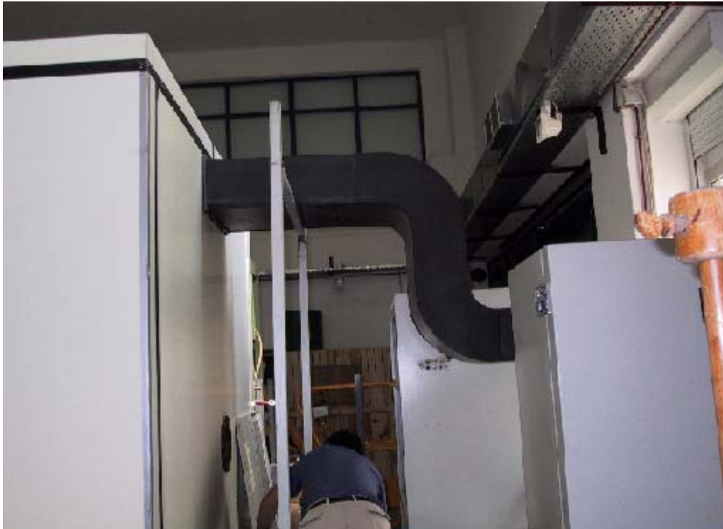
Εικόνα 4.7: Αεραγωγοί εισροής-εκροής αέρα στο θάλαμο εκκενώσεων από τη μονάδα παραγωγής αέρα
