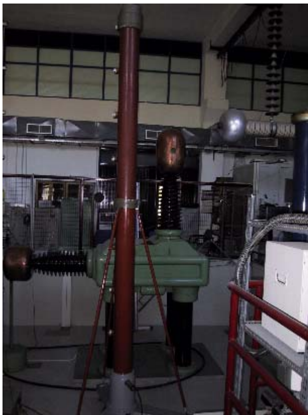
Εικόνα 5.4: Καταμεριστής τάσης στο εργαστήριο υψηλών τάσεων του Ε.Μ.Π.
