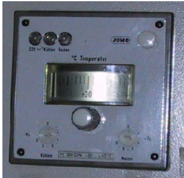
Εικόνα 4.6: Αυτόματος ελεγκτής θερμοκρασίας-υγρασίας
