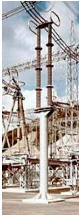
Σχήμα 1.6: Μονωτήρας τύπου post σε υποσταθμό [5].
