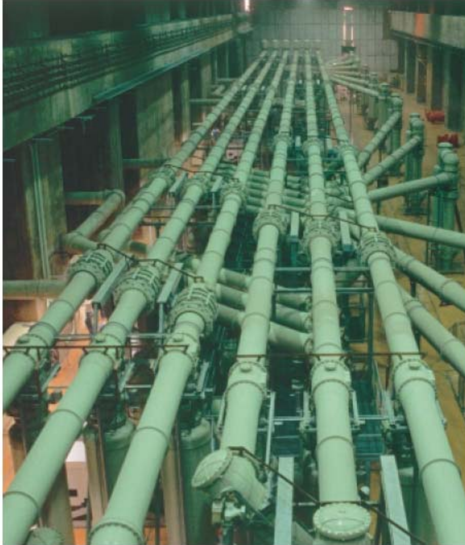
Σχήμα 2.3-3: Σταθμός διακοπών ΥΤ 550 kV με μόνωση SF 6 στον υδροηλεκτρικό σταθμό Itaipu στην Βραζιλία.
