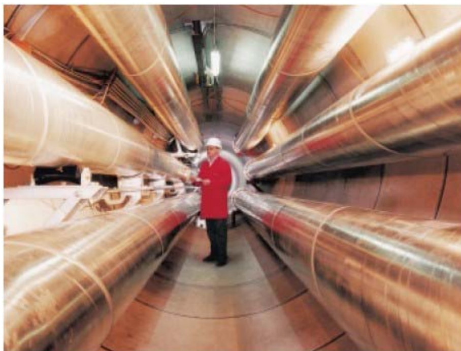
Σχήμα 2.3-4: Γραμμές μεταφοράς με μίγμα SF 6 και N 2 , σε τούνελ.
