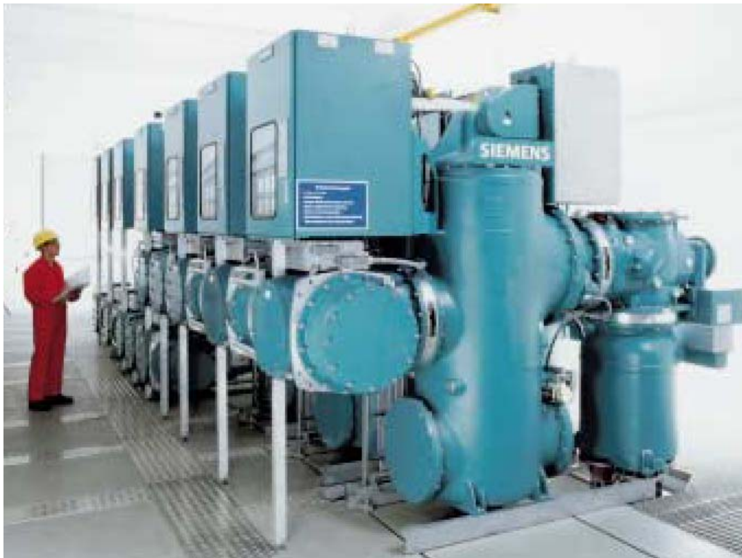
Σχήμα 2.3-2: Σταθμός διακοπών ΥΤ με μόνωση αερίου 145kV. (Siemens, Germany)
