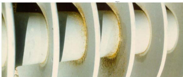
Σχήμα 3.5: Αλλοίωση στη διεπιφάνεια μεταξύ δίσκου και περιβλήματος του μονωτήρα
