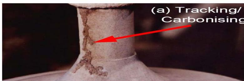
Σχήμα 3.18: Βλάβη στο περίβλημα μονωτήρα από αποσύνθεση της επιφάνειάς του
