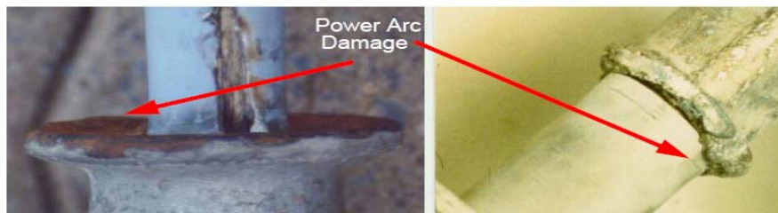
Σχήμα 3.13: Βλάβη στο μεταλλικό άκρο του μονωτήρα.
