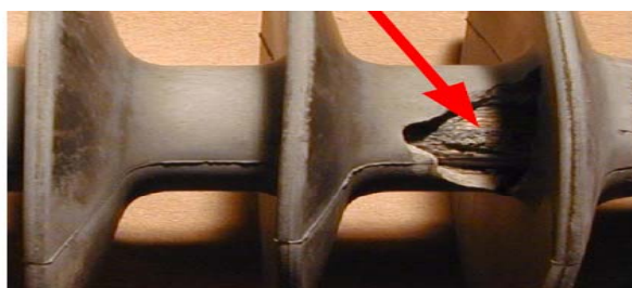
Σχήμα 3.9: Βλάβη στον πυρήνα του μονωτήρα λόγω έκθεσης του σε εξωτερικό περιβάλλον από θραύση / τομή του πολυμερούς περιβλήματος.
