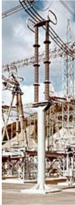
Σχήμα 1.4: Μονωτήρας τύπου post σε υποσταθμό.
