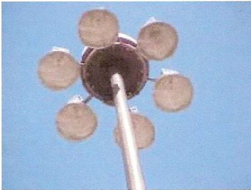
Εικόνα 3.4 Φωτιστικά σώματα υψηλού ιστού
