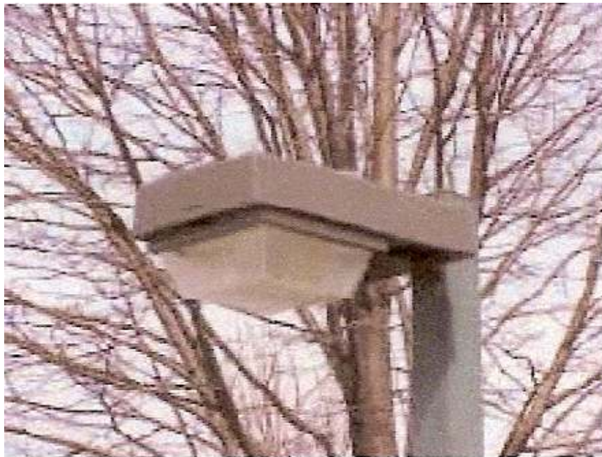
Εικόνα 3.5 Φωτιστικό σώμα χώρου στάθμευσης
