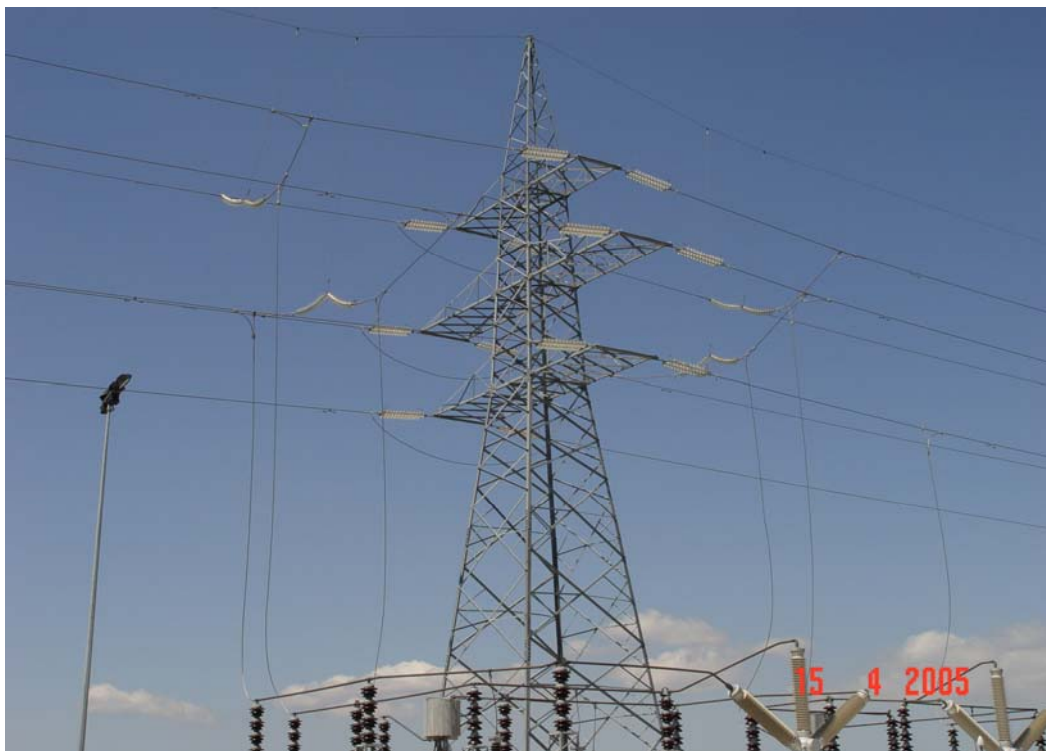
Σχήμα 1.9 Γυάλινοι μονωτήρες σε τερματικούς πυλώνες
