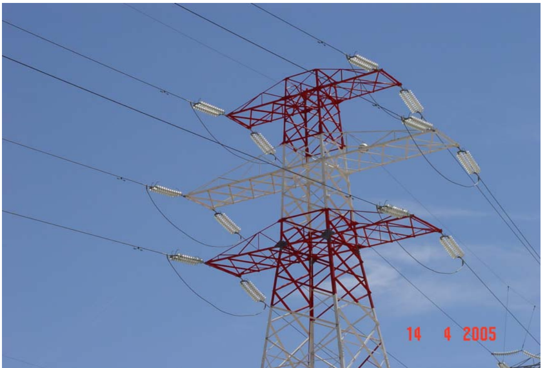
Σχήμα 1.14 Γυάλινοι μονωτήρες σε πυλώνα αεροδρομίου.
