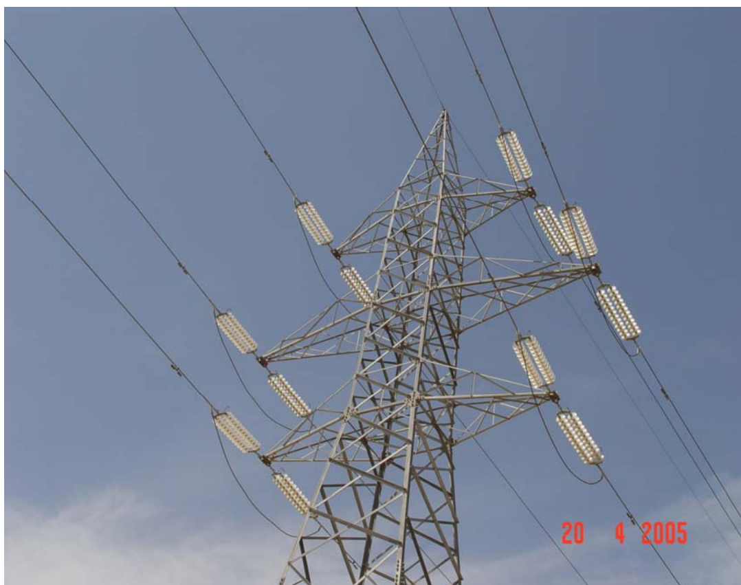
Σχήμα 1.10 Γυάλινοι μονωτήρες σε πυλώνες διέλευσης
