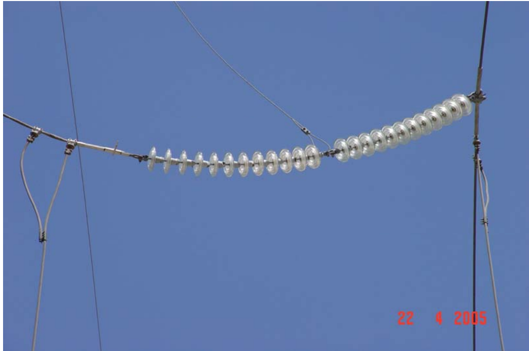
Σχήμα 1.15 Γυάλινοι μονωτήρες σε κατεβατά.
