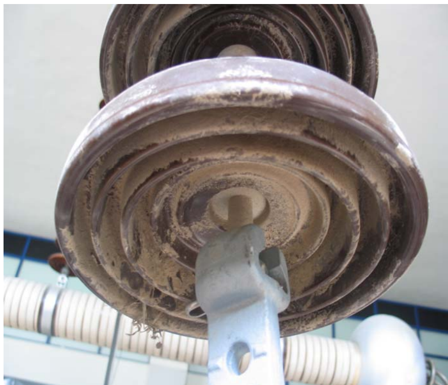
Σχήμα 4.1: Ρυπασμένος πορσελάνινος αλυσοειδής μονωτήρας (070), τύπου κανονικού 400 kV, αποτελούμενος από δεκαοκτώ (18) δισκοειδείς μονωτήρες,
