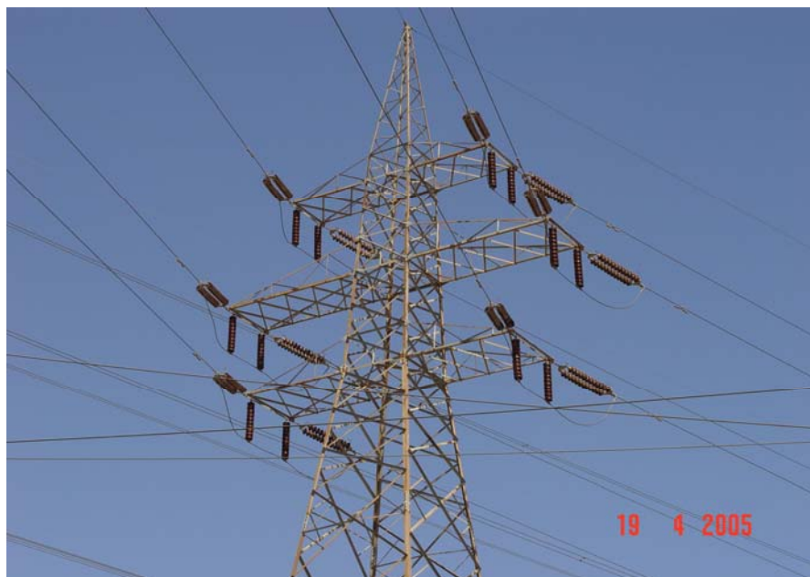
Σχήμα 1.19 Πορσελάνινοι μονωτήρες σε πυλώνες διέλευσης
