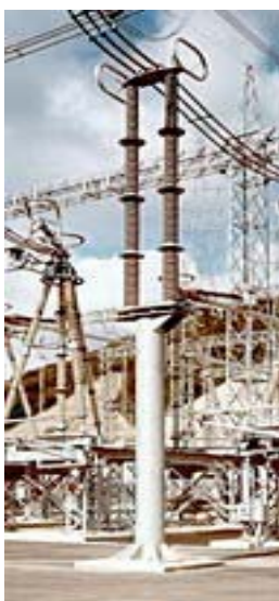
Σχήμα 1.4: Μονωτήρας τύπου post σε υποσταθμό.
