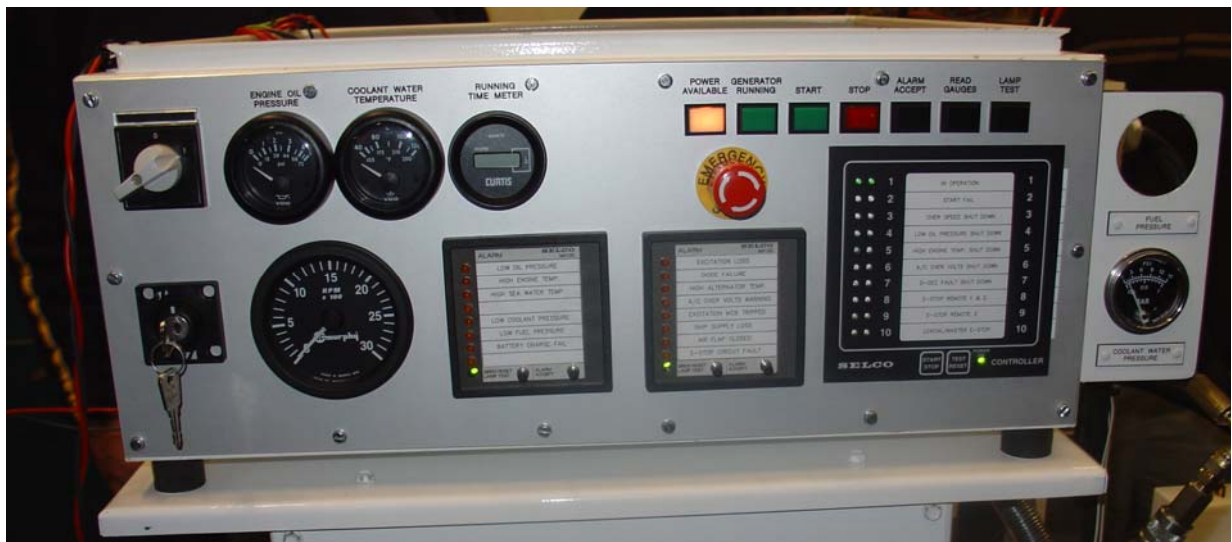
Σχήμα 47 : Ο τοπικός πίνακας ελέγχου ηλεκτρομηχανής
