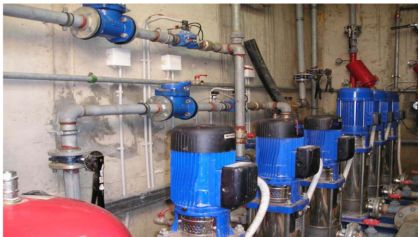
Εικόνα 1. Μερική άποψη του αντλιοστασίου
