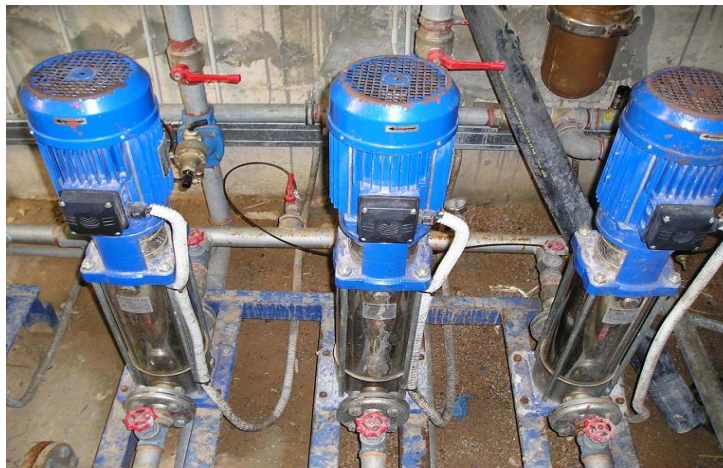
Εικόνα 2. Η δεύτερη ομάδα αντλιών (τροφοδοσία TRAM & Δήμου)
