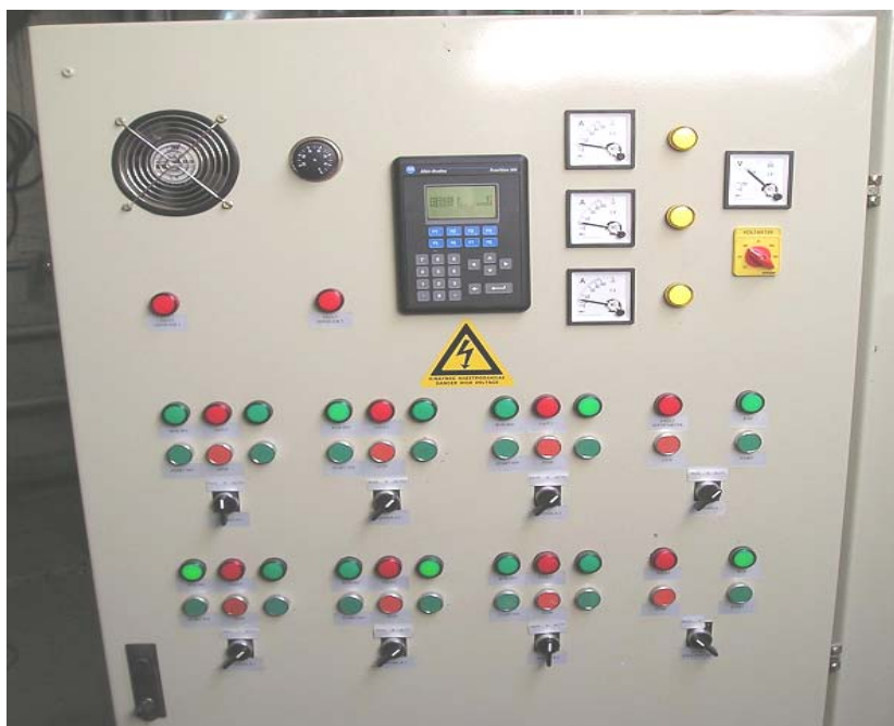
Εικόνα 4. Η μπροστινή πλευρά του ηλεκτρικού πίνακα
