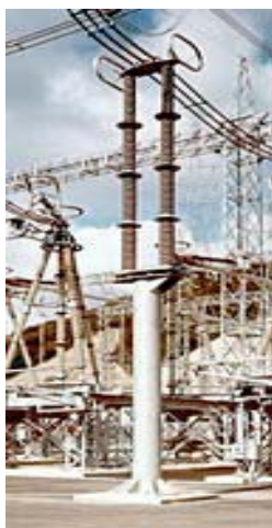
Σχήμα 1.9: Μονωτήρας τύπου station post σε υποσταθμό.
