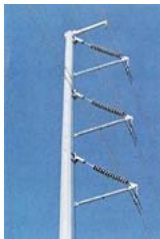
Σχήμα 1.10: Μονωτήρας τύπου line post σε γραμμή Υ.Τ.
