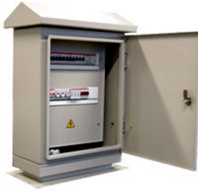
Σχήμα 6.28 Εξωτερικός πίνακας - Pillar
