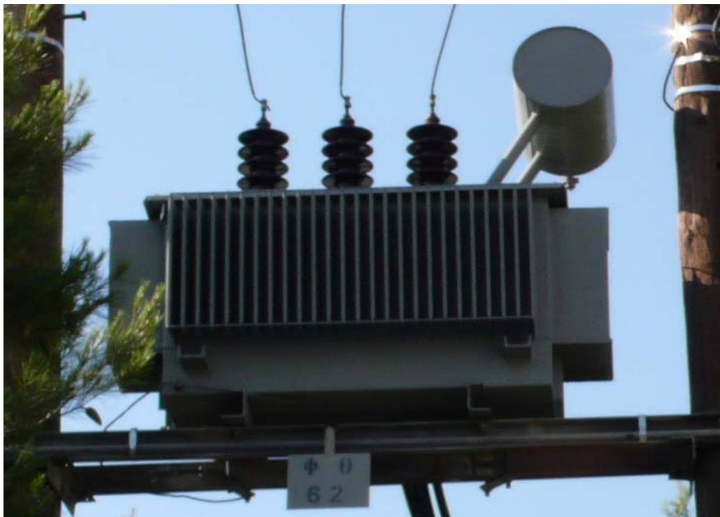
Εικόνα 2.3-7. Υποσταθμός 7 ος , Κομοτηνής και Μακεδονομάχων, Ισχύς 250 KVA.
