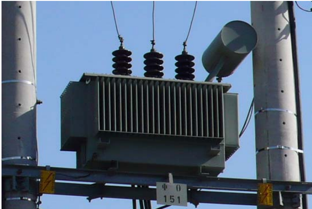
Εικόνα 2.3-6. Υποσταθμός 6 ος , Ορφέως και Ηφαιστίονος, Ισχύς 250 KVA.
