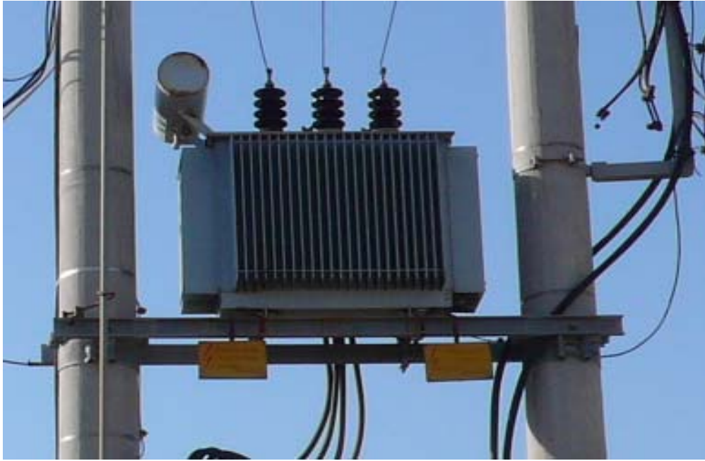
Εικόνα 2.3-12. Υποσταθμός 12 ος , Ζαφειράκη και Καρατάσου, Ισχύς 250 KVA.
