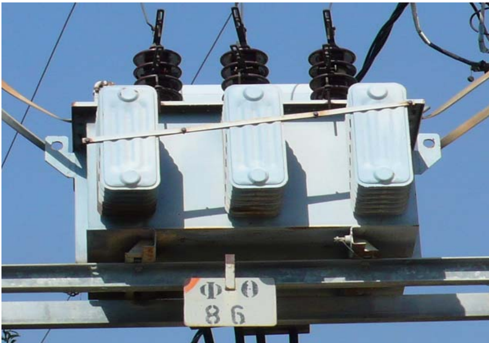
Εικόνα 2.3-5. Υποσταθμός 5 ος , Μακεδονίας και Καρατάσου, Ισχύς 250 KVA.
