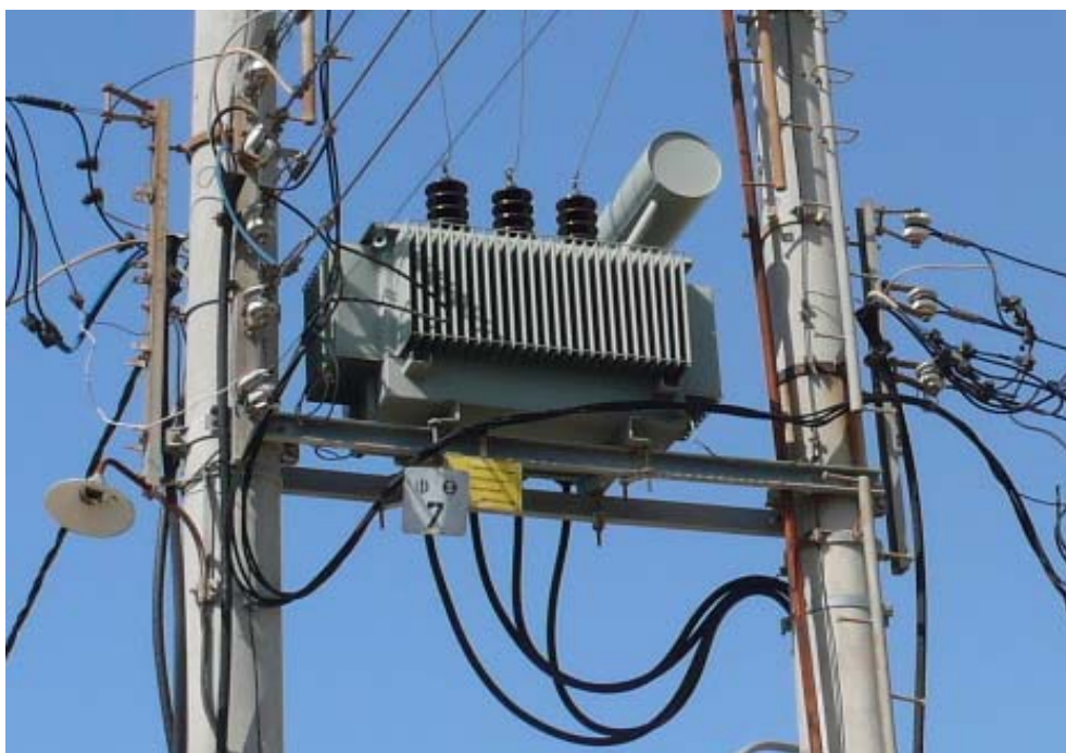
Εικόνα 2.3-1.Υποσταθμός 1 ος , Μεγ. Αλεξάνδρου και Ολυμπίων, Ισχύς 250 KVA.
