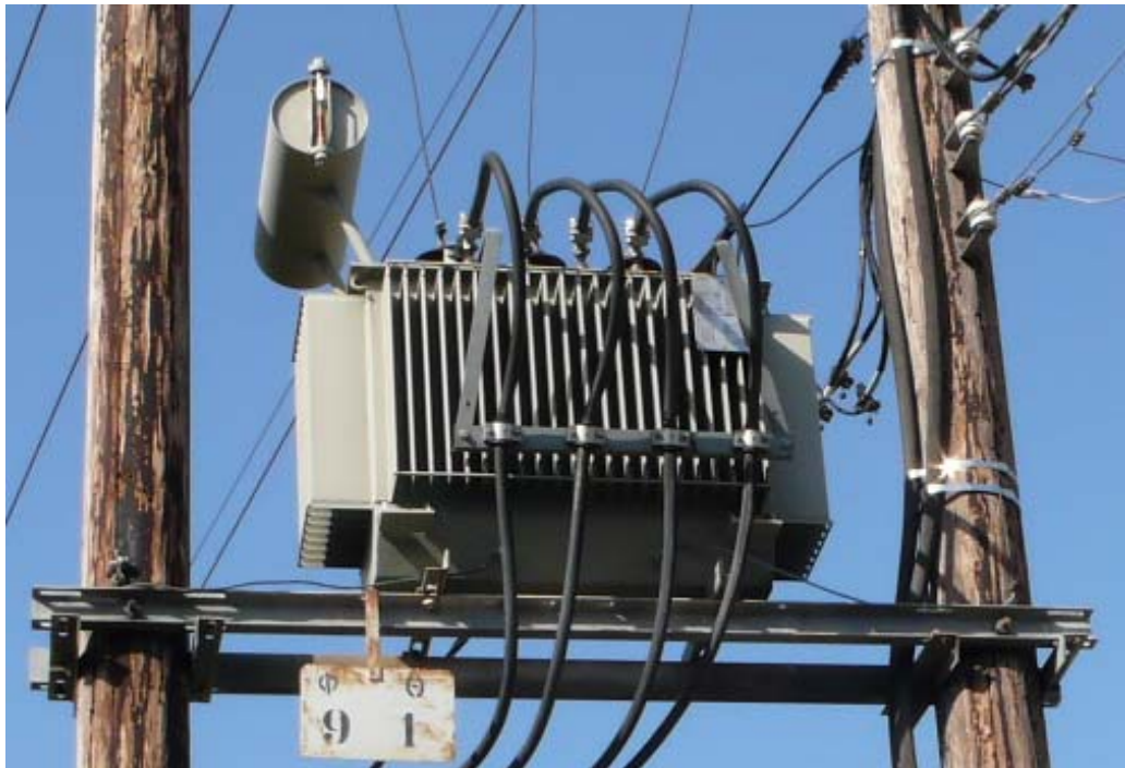
Εικόνα 2.3-9. Υποσταθμός 9 ος , Φιλλίπου Β και Αμόντα, Ισχύς 250 KVA.
