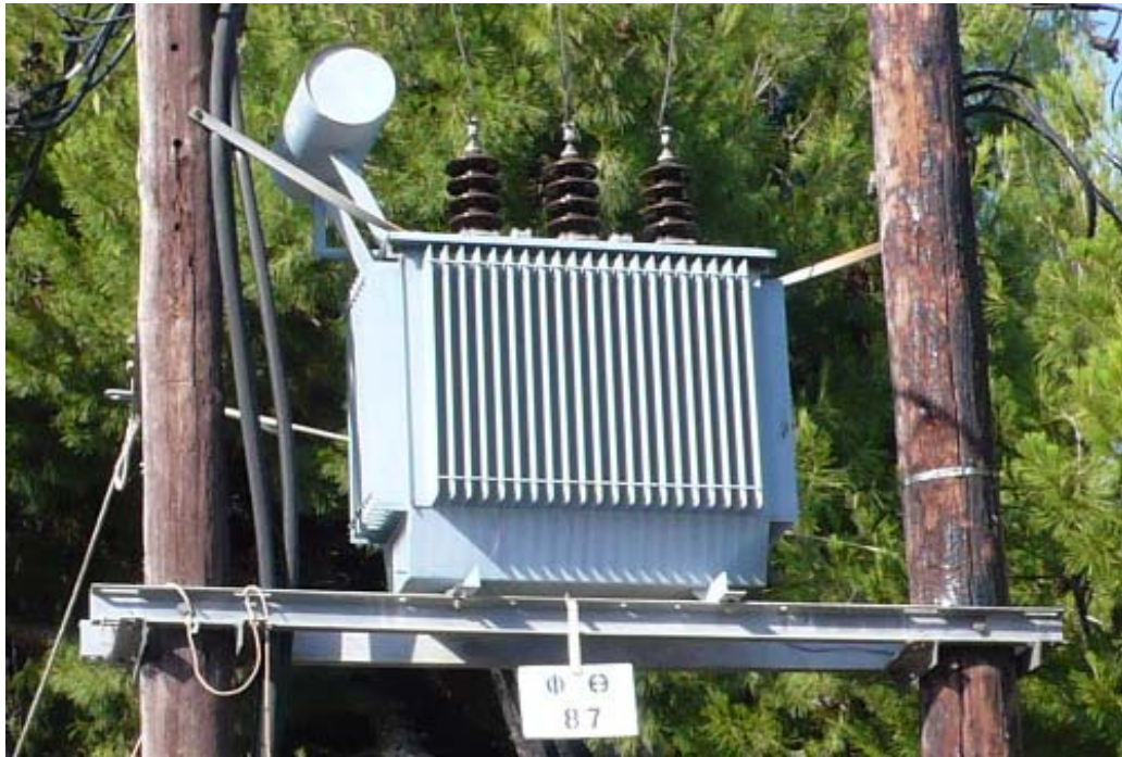
Εικόνα 2.3-10. Υποσταθμός 10 ος , Παρμενίωνος και Πρωταγόρα, Ισχύς 250 KVA.
