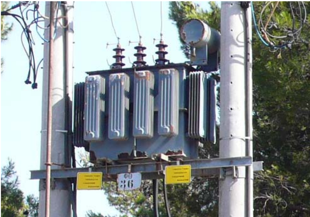
Εικόνα 2.3-3.Υποσταθμός 3 ος , Μεγ. Αλεξάνδρου και Θάσος, Ισχύς 250 KVA.
