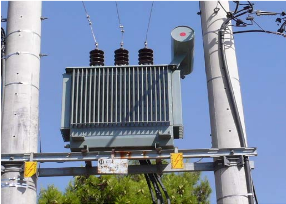
Εικόνα 2.3-2.Υποσταθμός 2 ος , Μεγ. Αλεξάνδρου και Πρωταγόρα, Ισχύς 250 KVA.
