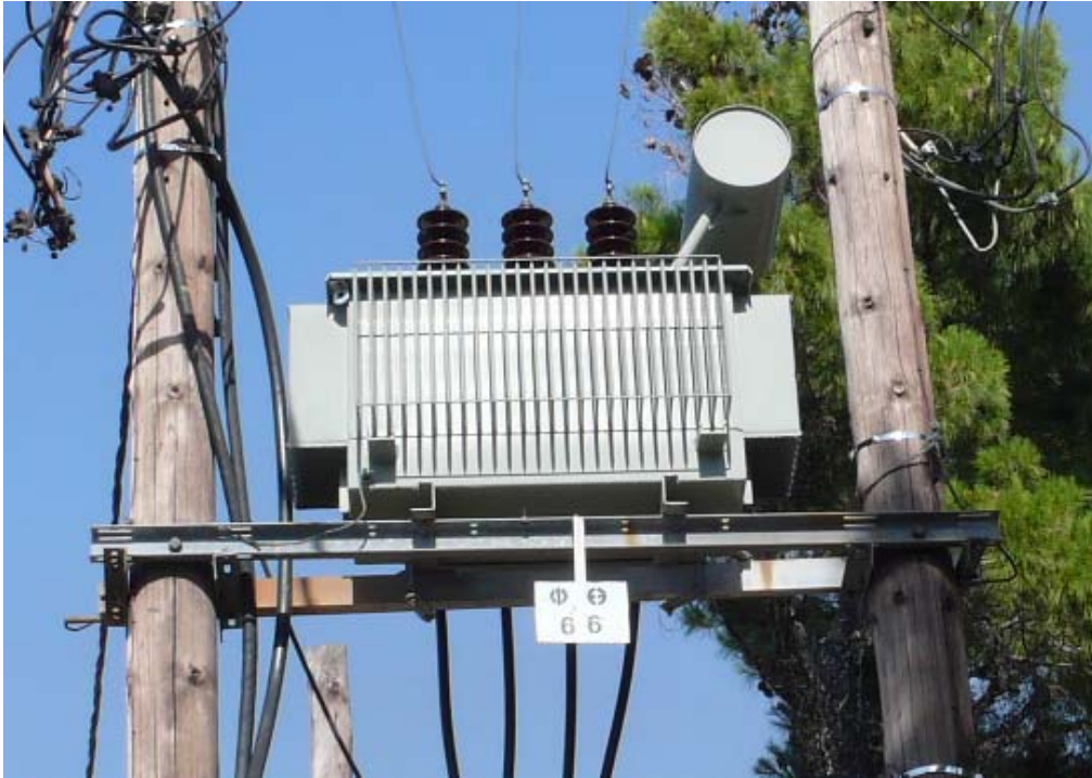
Εικόνα 2.3-4. Υποσταθμός 4 ος , Μακεδονίας και Ανδριανουπόλεως, Ισχύς 250 KVA.
