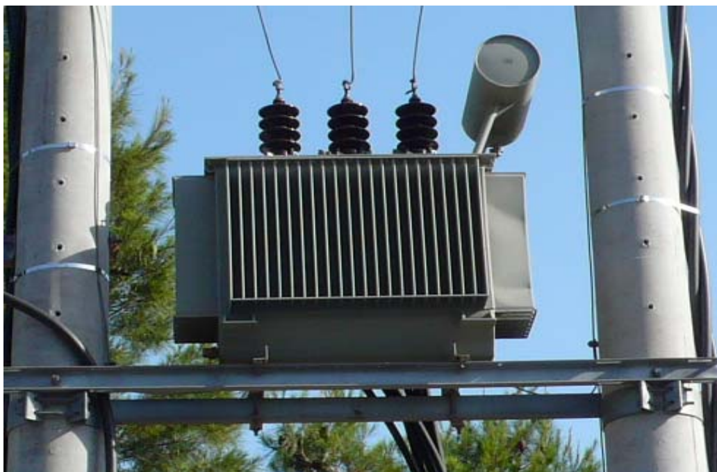
Εικόνα 2.3-11. Υποσταθμός 11 ος , Πλατεία και Ορφέως, Ισχύς 250 KVA.
