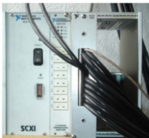
Εικόνα 1.2.2.2-2. Ενισχυτής σημάτων θερμοστοιχείων : φαίνονται οι κενές θέσεις σύνδεσης για οκτώ τυποποιημένες υποδοχές θερμοστοιχείων.
