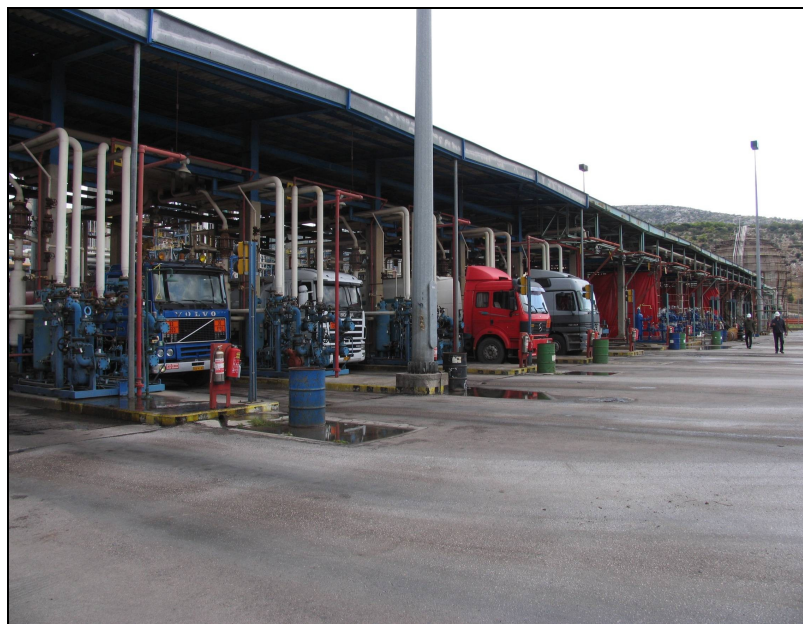
Εικόνα 4.8. Σταθμός φόρτωσης Β/Φ.
