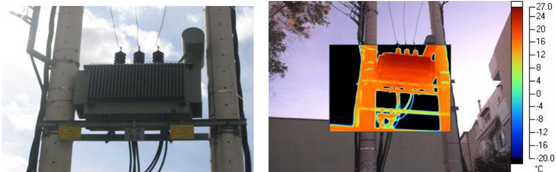
Εικόνα 4.1.11α : Μετασχηματιστής του 11 ου υποσταθμού : Ισχύς - 250 KVA, Θερμοκρασία περιβάλλοντος – 17,5 °C, Σχετική υγρασία – 28,7 %
