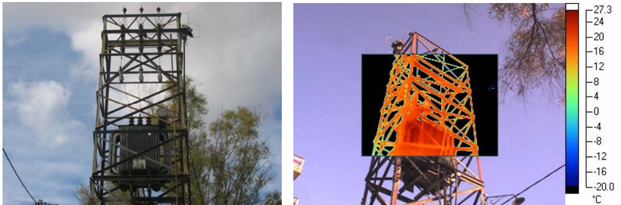
Εικόνα 4.1.12β : Διάταξη ασφαλειών του 12 ου υποσταθμού
