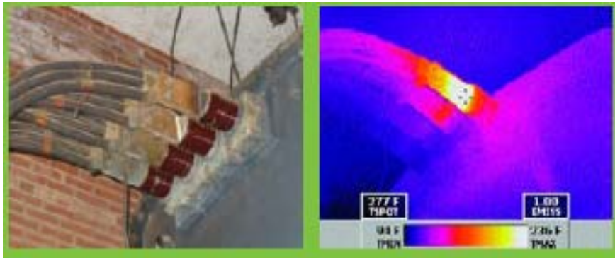
Εικόνα 3.7.4 : Ακροδέκτες μετασχηματιστή σε συμβατική και θερμική απεικόνιση – παρατηρείται υπερθέρμανση σε έναν από τους ακροδέκτες
