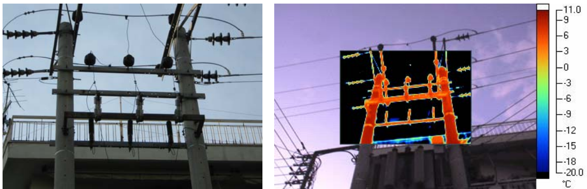
Εικόνα 4.1.5β : Διάταξη ασφαλειών του 5 ου υποσταθμού
