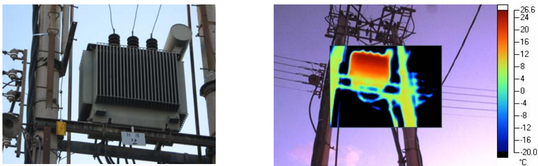
Εικόνα 4.1.7α : Μετασχηματιστής του 7 ου υποσταθμού : Ισχύς - 400 KVA, Θερμοκρασία περιβάλλοντος – 8,5 °C, Σχετική υγρασία – 40 %
