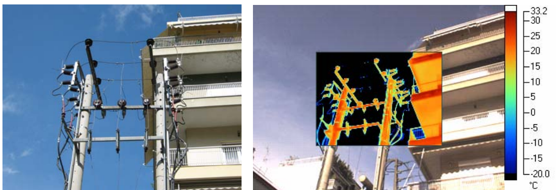
Εικόνα 4.2.4β : Διάταξη ασφαλειών του 4 ου υποσταθμού
