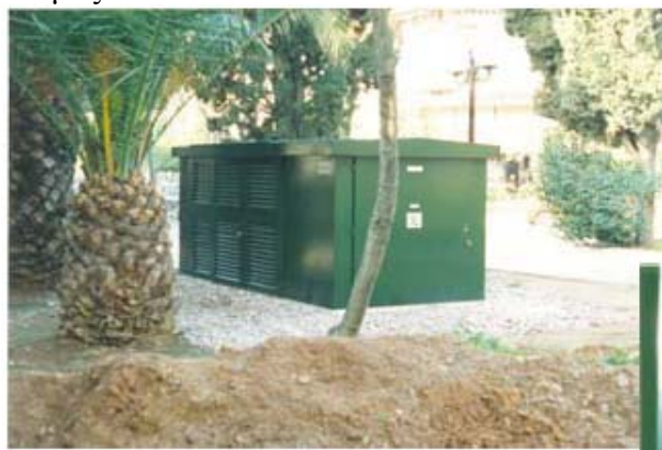
Εικόνα 1.5.1 : Επίγειος υποσταθμός διανομής
