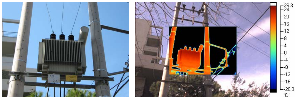
Εικόνα 4.2.2α : Μετασχηματιστής του 2 ου υποσταθμού : Ισχύς - 400 KVA, Θερμοκρασία περιβάλλοντος – 16,6 °C, Σχετική υγρασία – 37,7 %
