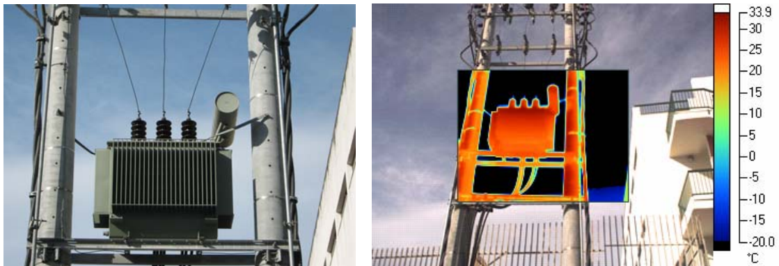
Εικόνα 4.2.7α : Μετασχηματιστής του 7 ου υποσταθμού : Ισχύς - 400 KVA, Θερμοκρασία περιβάλλοντος – 16,4 °C, Σχετική υγρασία – 36,1 %
