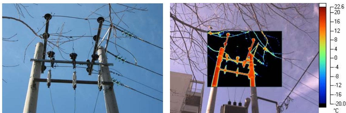
Εικόνα 4.2.2β : Διάταξη ασφαλειών του 2 ου υποσταθμού
