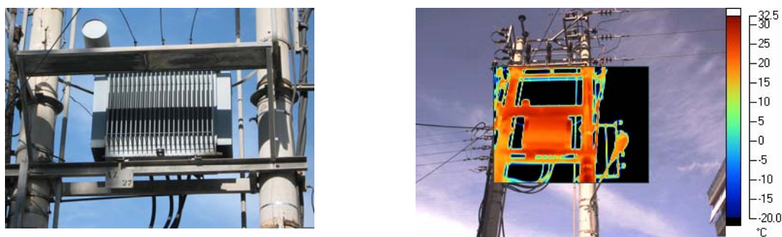
Εικόνα 4.2.3α : Μετασχηματιστής του 3 ου υποσταθμού : Ισχύς - 400 KVA, Θερμοκρασία περιβάλλοντος – 15,8 °C, Σχετική υγρασία – 38 %
