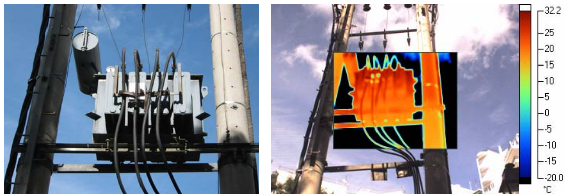
Εικόνα 4.2.5α : Μετασχηματιστής του 5 ου υποσταθμού : Ισχύς - 400 KVA, Θερμοκρασία περιβάλλοντος – 15,7 °C, Σχετική υγρασία – 38 %
