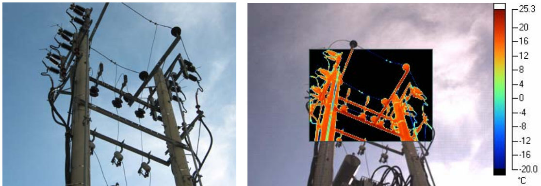
Εικόνα 4.2.6β : Διάταξη ασφαλειών του 6 ου υποσταθμού
