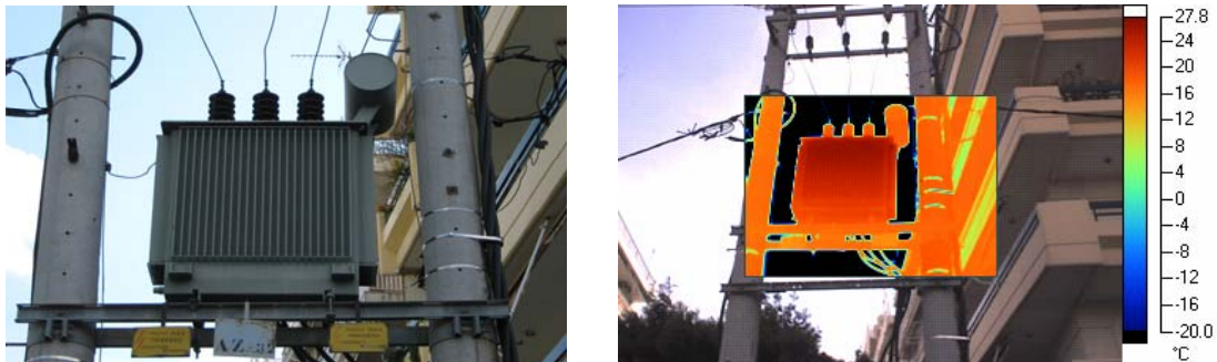
Εικόνα 4.2.1α : Μετασχηματιστής του 1 ου υποσταθμού : Ισχύς - 400 KVA, Θερμοκρασία περιβάλλοντος – 16 °C, Σχετική υγρασία – 32,7 %
