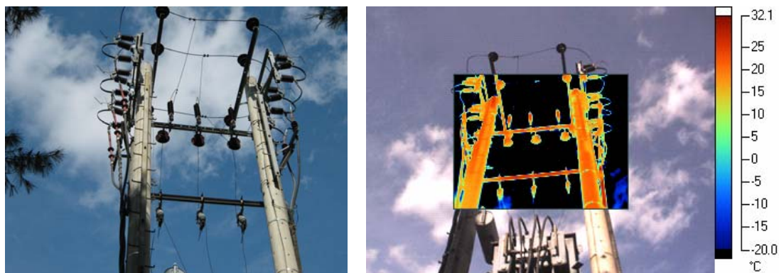
Εικόνα 4.2.5β : Διάταξη ασφαλειών του 5 ου υποσταθμού
