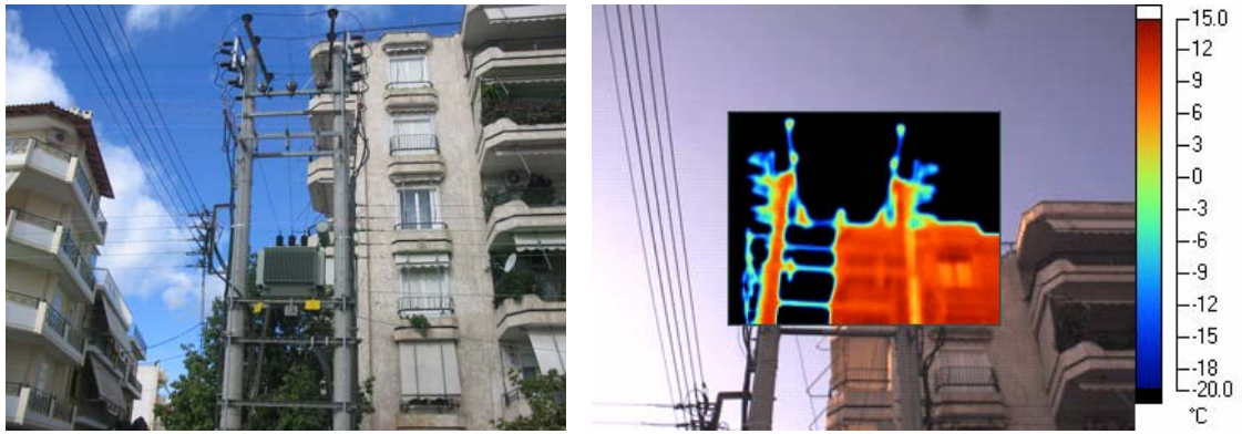
Εικόνα 4.1.1β : Διάταξη ασφαλειών του 1 ου υποσταθμού.
