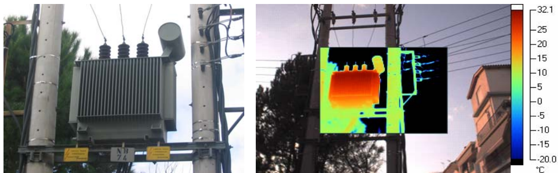
Εικόνα 4.1.3α : Μετασχηματιστής του 3 ου υποσταθμού : Ισχύς - 400 KVA, Θερμοκρασία περιβάλλοντος – 8,9 °C, Σχετική υγρασία – 39,1 %
