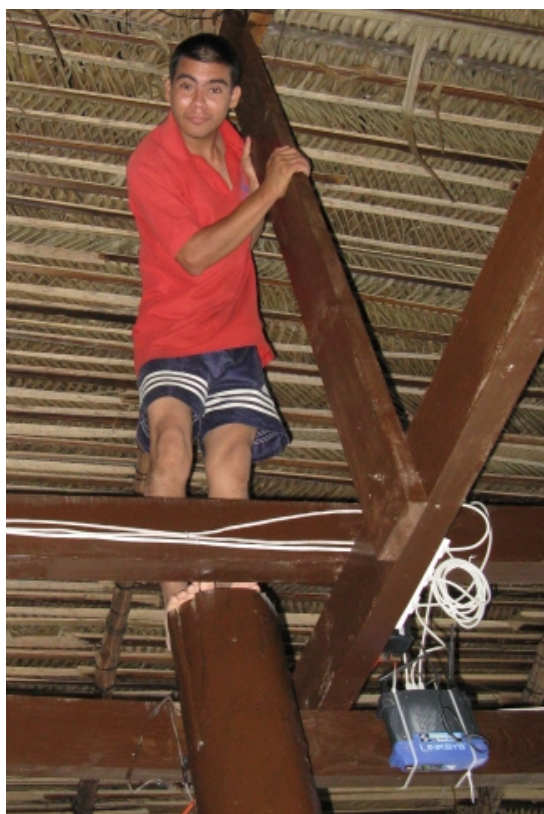
Φωτογραφία 3.1. : Εγκατάσταση του δικτύου. Ο Lyonel, υπάλληλος του ξενοδοχείου και πρώην παιδί της Casa Guatemala, μας βοηθάει να τοποθετήσουμε τον router στην οροφή του εστιατορίου.
