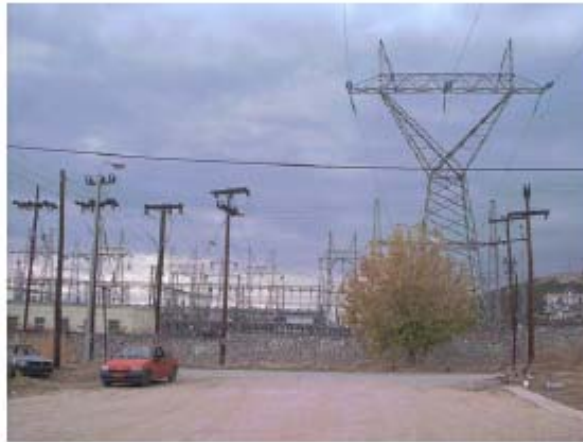
Σχήμα 1.9: Φωτογραφία Κέντρου Υπερψηλής Τάσης (ΚΥΤ). [6]
