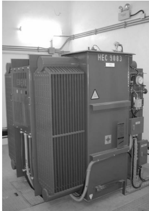
Σχήμα 2.2: Μετασχηματιστής SF 6 22kV/390V ισχύος 1500kVA[13].
