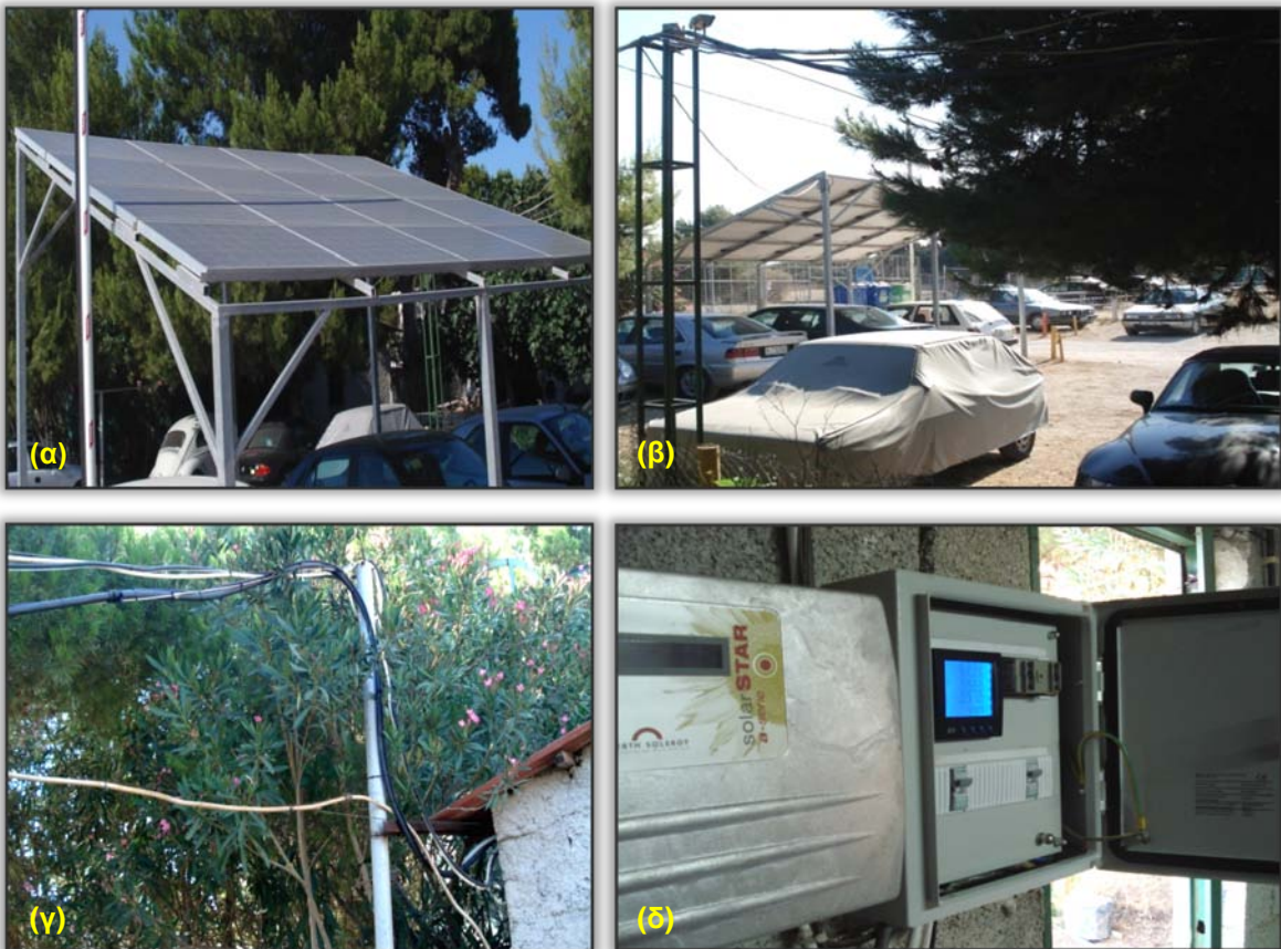
Εικόνα 3.4: Εγκατάσταση φ/β πάρκου στην Ραφήνα
