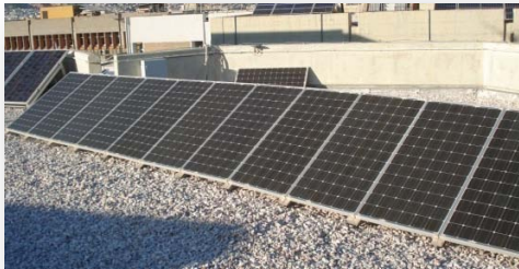
Εικόνα 8.3 : Φωτοβολταϊκά πλαίσια εργαστηριακού μικροδικτύου
