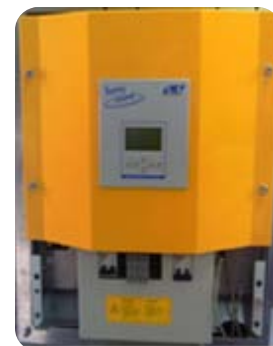
Σχήμα 8.8 : Αντιστροφέας συσσωρευτών αυτόνομου δικτύου
