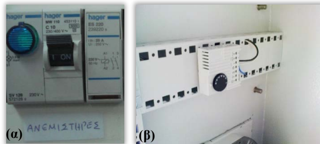
Εικόνα 8.18: (α) διακόπτης χειρισμού των ανεμιστήρων (β) θερμοστάτης στο ερμάριο του προσομοιωτή φορτίου
