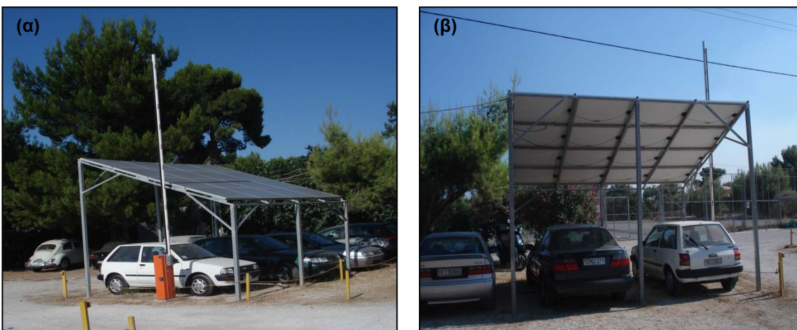
Εικόνα 3.1: Φωτοβολταϊκό πάρκο Ραφήνας στην θέση της κεντρικής εισόδου (α) Πλάγια όψη (β) Πίσω όψη
