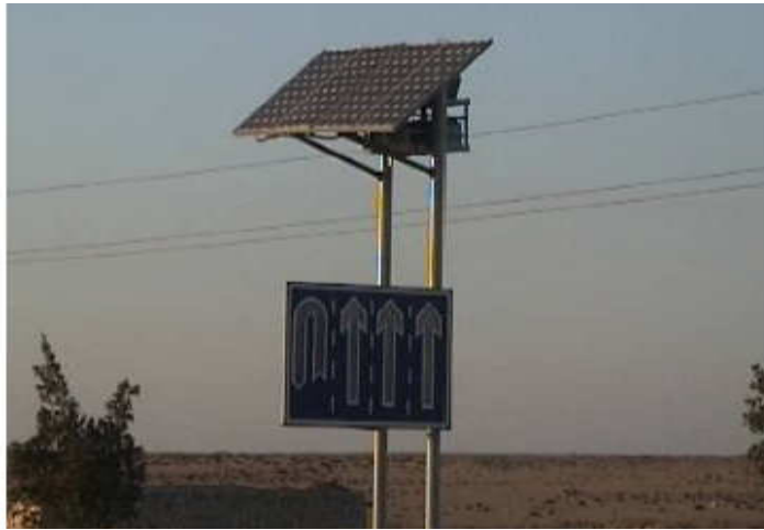
Σχήμα 5.7 Ηλεκτροδότηση οδικού φωτισμού στην Αίγυπτο
