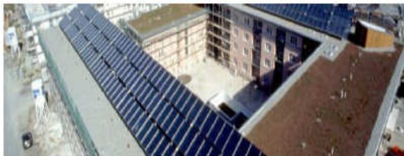
Σχήμα 3.4 Ηλιακά συστήματα στην οροφή κτιρίου
