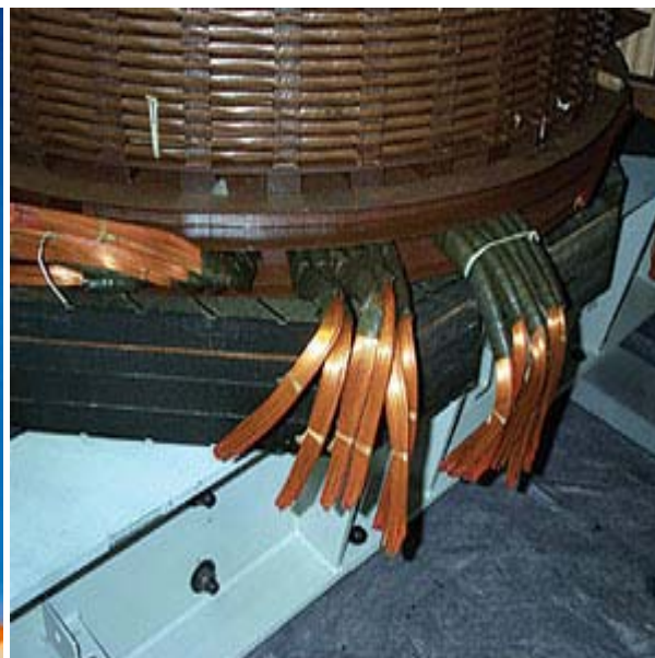
Σχήμα 4.10: Εφαρμογή της συνεχούς αντιμετάθεσης αγωγών σε έναν μεγάλο μετασχηματιστή [9]
