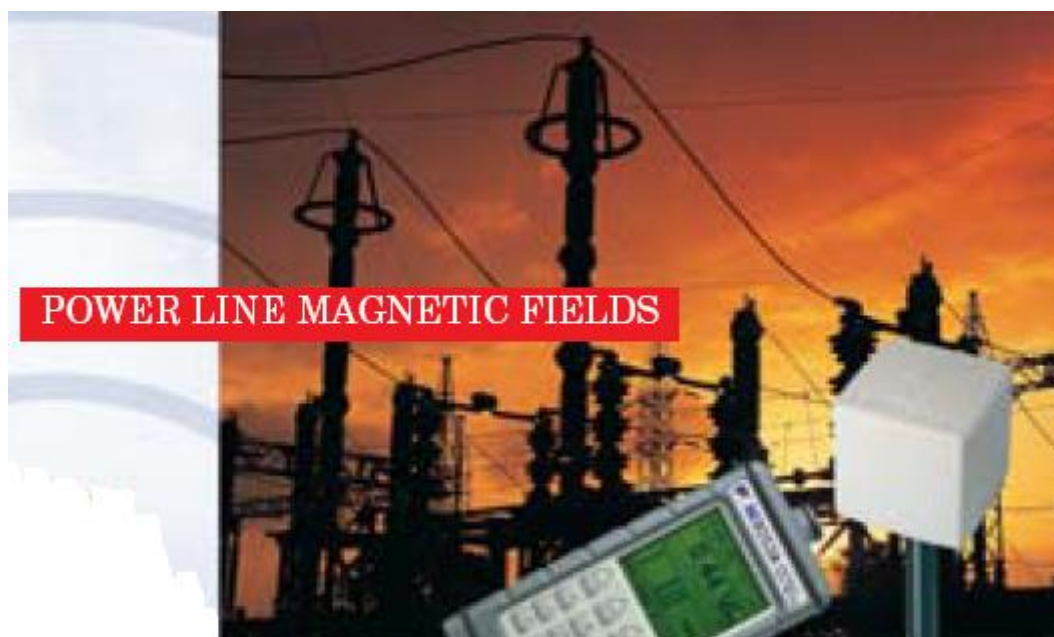
Σχήμα Α.6: Μέτρηση ηλεκτρικού και μαγνητικού πεδίου σε υποσταθμούς τάσης
