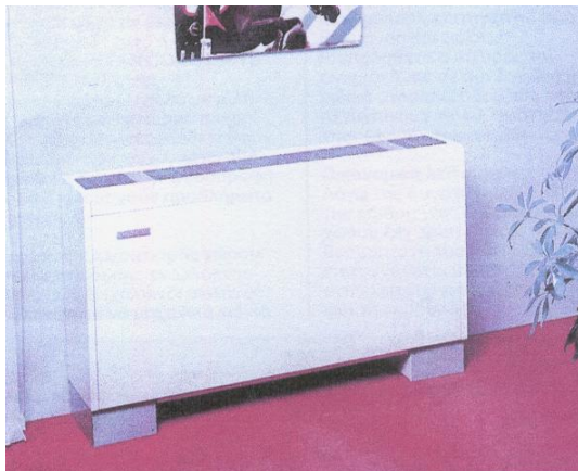
Σχήμα 7. 29 Fan Coil δαπέδου (εμφανές) σε αίθουσα γραφείων.
