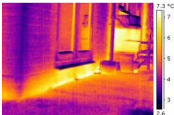
Εικόνα 3.5: Κακή τοποθέτηση θερμομονωτικής πλάκας
