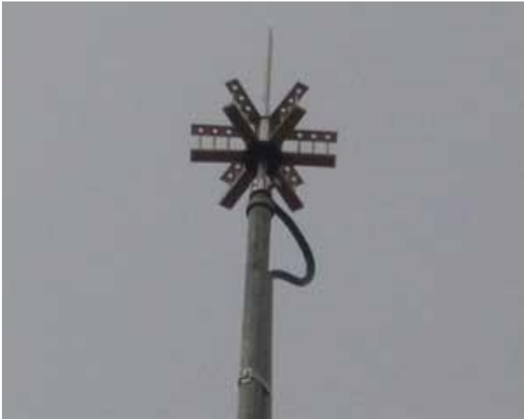
Εικόνα 4 Τα αλεξικέραυνα ιονισμού δεν είναι καλύτερα από αυτά της απλής ακίδας [4] Χαρακτηριστικά αναφέρεται «ESE air terminal works no better than ordinary Franklin rod (FR), despite techno-babble from vendor. ESE cost $1800; FR cost $2.40» [4].
