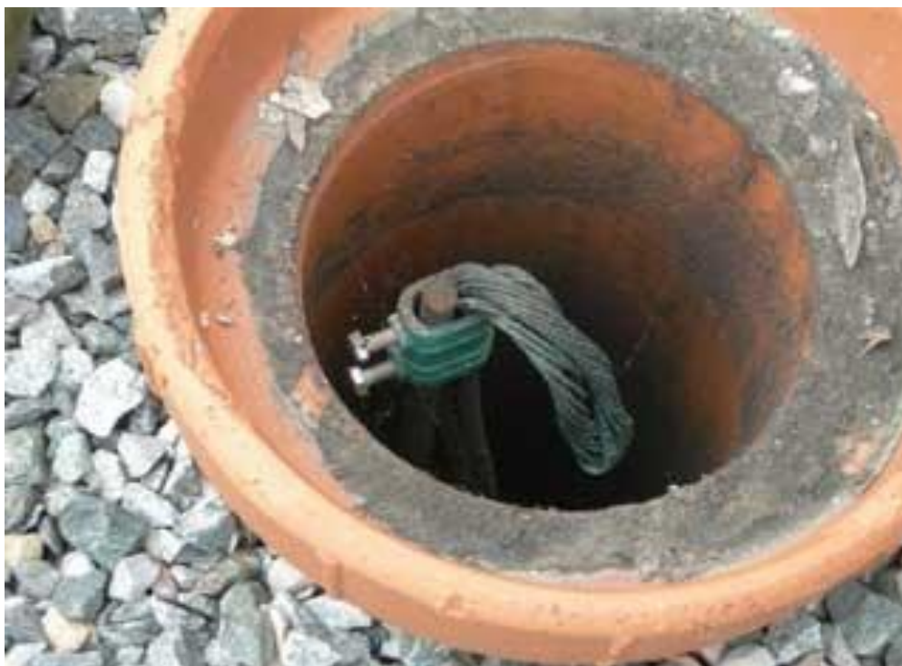
Εικόνα 6.4 Πρώιμο στάδιο διάβρωσης σε ηλεκτρόδιο γείωσης [7] Η κατασκευή φρεατίων γείωσης διευκολύνει την διεξαγωγή επιθεώρησης στο σύστημα γείωσης γι αυτό και συνίσταται. Σε περίπτωση μη κατασκευής θα πρέπει κατά την αρχική εγκατάσταση να λαμβάνονται από τον αρμόδιο φορέα παραλαβής του έργου φωτογραφίες πιστοποίησης της καλής εγκατάστασης.
