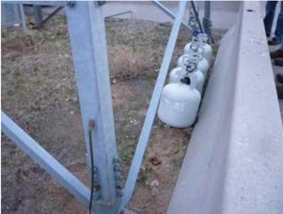
Εικόνα 6.3 Παράδειγμα αμέλειας με τοποθέτηση φιαλών προπανίου κοντά σε αγωγό καθόδου [7].
