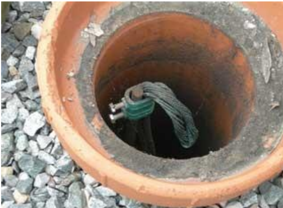
Εικόνα 6.4 Πρώιμο στάδιο διάβρωσης σε ηλεκτρόδιο γείωσης [7] Η κατασκευή φρεατίων γείωσης διευκολύνει την διεξαγωγή επιθεώρησης στο σύστημα γείωσης γι αυτό και συνίσταται. Σε περίπτωση μη κατασκευής θα πρέπει κατά την αρχική εγκατάσταση να λαμβάνονται από τον αρμόδιο φορέα παραλαβής του έργου φωτογραφίες πιστοποίησης της καλής εγκατάστασης.
