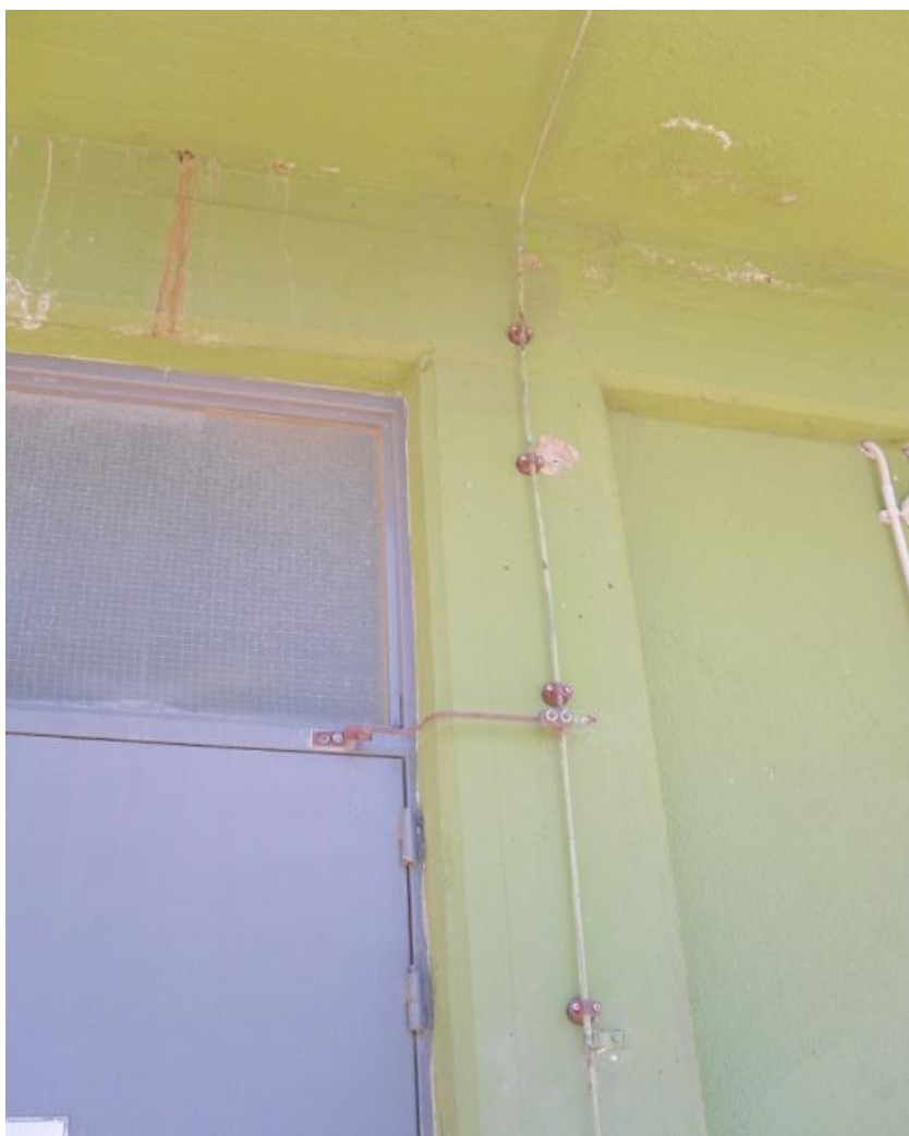
Εικόνα 5.1 Σύνδεση εξωτερικής μεταλλικής πόρτας στο εξωτερικό ΣΑΠ λόγω παραβίασης της απόστασης ασφαλείας s (Φωτογραφία που λήφθηκε για την εκπόνηση της παρούσας εργασίας).
