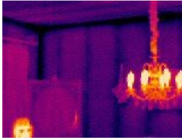
Εικόνα 3.3.1.15 Πιθανή έλλειψη εξωτερικής μόνωσης αφρού που καθιστά τον τοίχο τρεις φορές πιο αγωγίμο θερμικά από ότι αν ήταν μονωμένος και οδηγεί στη δημιουργία θερμογέφυρας.
