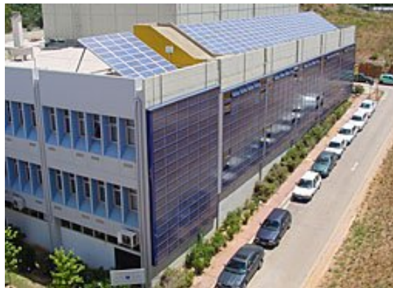
Εικόνα 4.1.2 Φωτογραφία φωτοβολταϊκών συστοιχιών στο κτίριο των Χημικών Μηχανικών
