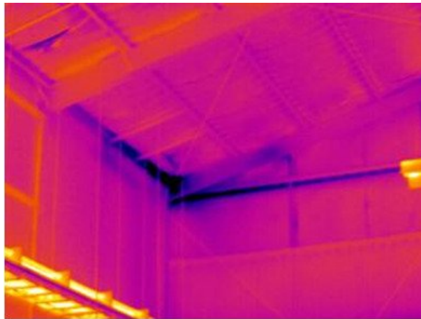
Εικόνα 3.3.3.7 Αποτυχημένη κατασκευή στέγης επαγγελματικού χώρου.
