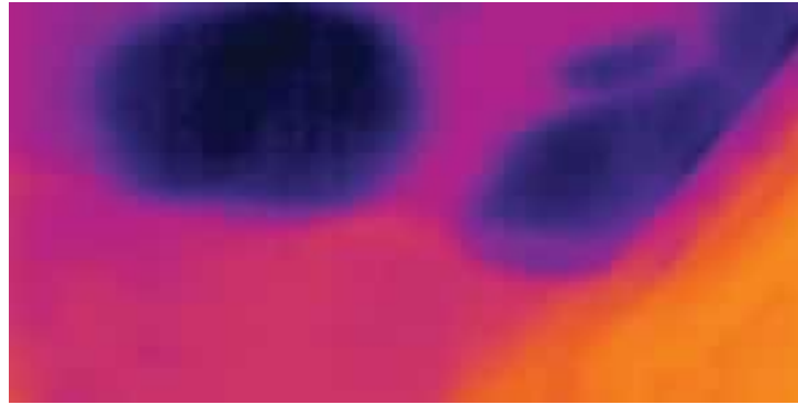
Εικόνα 3.3.5.26 Υγρασία στην οροφή
