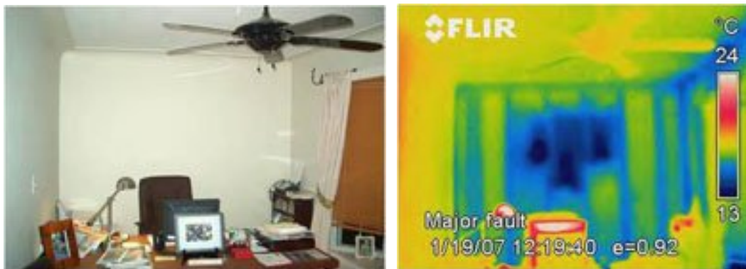
Εικόνα 3.3.2.10 Ψηφιακή φωτογραφία και θερμοφωτογραφία του εσωτερικού ενός γραφείου που αποδεικνύει την απουσία μόνωσης.
