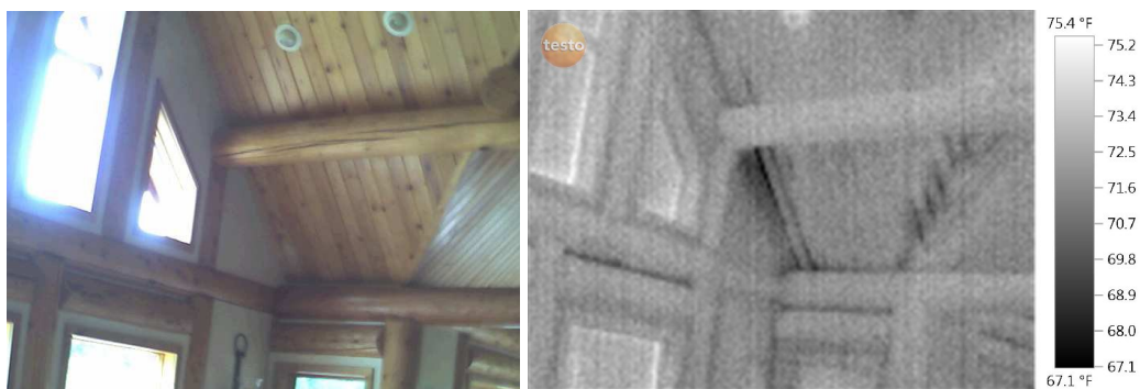
Εικόνα 3.3.7.11 Οι σκοτεινές ραβδώσεις παρουσιάζουν διαρροή αέρα στη στέγη και ιδιαίτερα στο σημείο σύνδεσής της με τον τοίχο.
