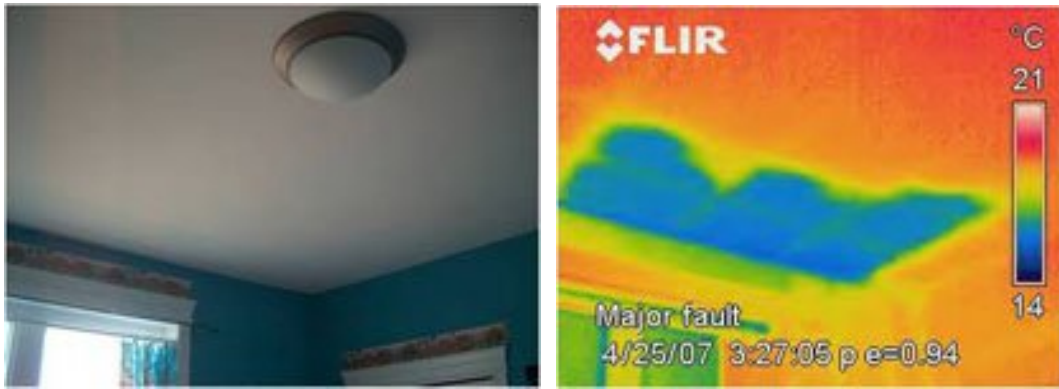
Εικόνα 3.3.2.11 Ψηφιακή φωτογραφία και θερμοφωτογραφία του εσωτερικού ενός υπνοδωματίου που αποδεικνύει την έλλειψη μόνωσης στην οροφή.
