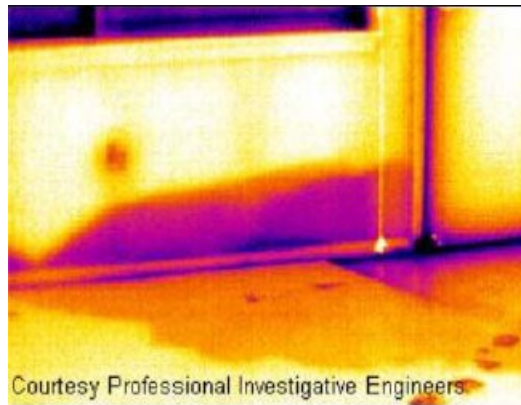
Εικόνα 3.3.5.35 Μετανάστευση υγρασίας μέσα στο στεγνό τοίχο λόγω φαινομένων τριχοειδούς και σε εσωτερικά τελειώματα λόγω ανεπαρκούς διακένου και κλίσης βαθμίδας από πρόσοψη με πλευρική επένδυση βινυλίου σε συγκρότημα διαμερισμάτων.
