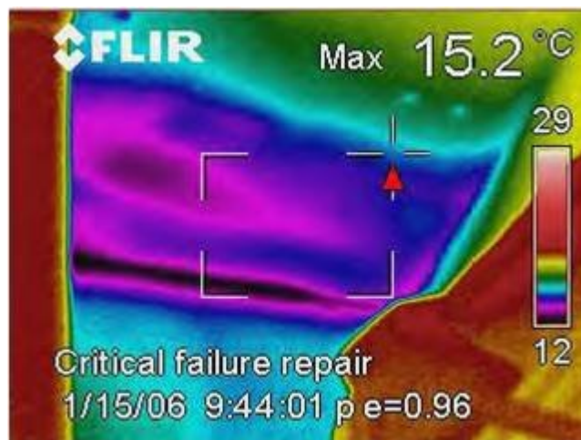
Εικόνα 3.3.2.5 Απουσία μόνωσης σε οροφή.
