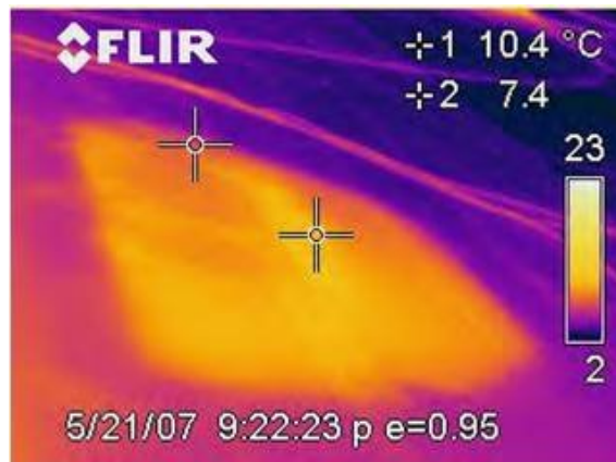
Εικόνα 3.3.3.4 Υγρασίας τη μόνωση κάτω από μια επίπεδη στέγη που παρουσιάζει διαρροή σε σημεία τα οποία φαίνονται πιο ζεστά καθώς η υγρασία κρατά τη θερμότητα από τον ήλιο της μέρας περισσότερο από τη μόνωση.
