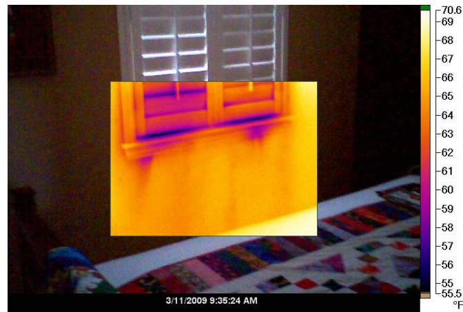
Εικόνα 3.3.7.45 Διαρροή κρύου αέρα σε κακώς τοποθετημένο παράθυρο
