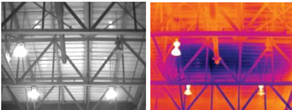
Εικόνα 3.3.5.21 Η υπέρυθρη έρευνα που πραγματοποιήθηκε στο εσωτερικό κατά τη διάρκεια των πρωινών ωρών αποκαλύπτει ότι η κεντρική περιοχή της οροφής της αποθήκης που είναι ταυτόχρονα και στέγη έχει υγρασία, γεγονός που απαιτεί άμεση επισκευή
