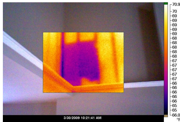
Εικόνα 3.3.2.15 Μη μονωμένες περιοχές που σε κρύο καιρό φαίνονται σκουρόχρωμες στη θερμοφωτογράφηση.
