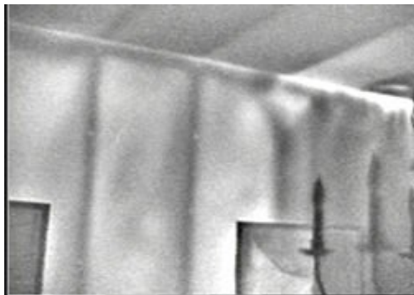
Εικόνα 3.3.1.9 Οι κρύες περιοχές του τοίχου της θερμοφωτογραφίας προκαλούνται από τα στηρίγματα που λειτουργούν ως θερμογέφυρα.
