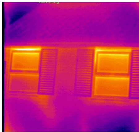
Εικόνα 3.3.7.14 Ο θερμός αέρας διαρρέει προς τα έξω από το ανοιχτό τμήμα του αριστερού παραθύρου (φωτεινή περιοχή κατά μήκος της πάνω άκρης του παραθύρου), το οποίο δεν σφραγίζεται κατάλληλα όταν κλείνει.
