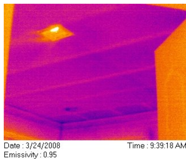
Εικόνα 3.3.2.17 Παντελής έλλειψη μόνωσης σε σοφίτα υπερπολυτελούς σουίτας.
