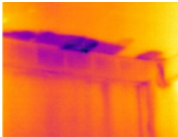
Εικόνα 3.3.1.24 Θερμογέφυρα στο σημείο συνάντησης τοίχου και ταβανιού
