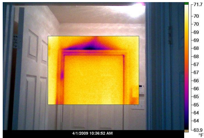
Εικόνα 3.3.6.13 Διείσδυση κρύου αέρα από κακώς σφραγισμένο πλαίσιο πόρτας.
