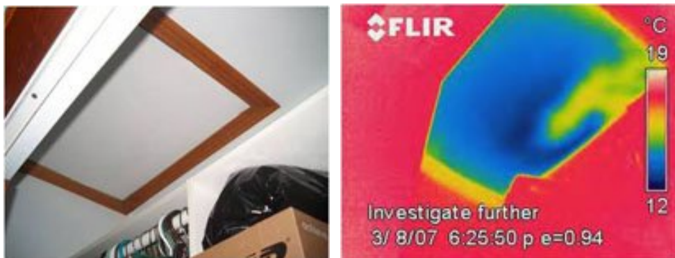
Εικόνα 3.3.2.12 Ψηφιακή φωτογραφία και θερμοφωτογραφία ενός σημείου πρόσβασης σε σοφίτα μέσα σε ένα μικρό δωμάτιο.
