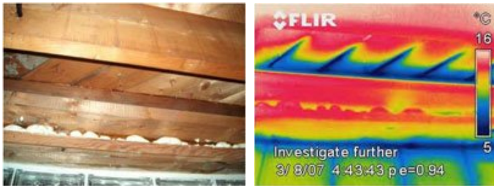
Εικόνα 3.3.2.14 Φωτογραφίες από την κάτω πλευρά ενός πατώματος τραβηγμένες από το υπόγειο που δείχνουν διαρροές αέρα κατά μήκος των σανίδων.
