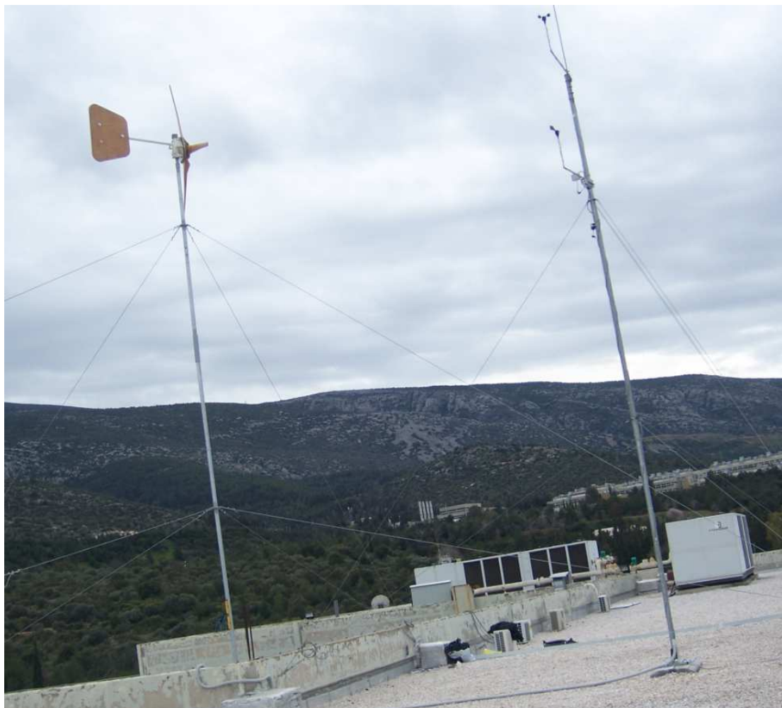
Εικόνα 8.5 : Η μικρή ανεμογεννήτρια κι ο μετεωρολογικός ιστός στην οροφή του παλαιού κτιρίου της Σχολής ΗΜΜΥ (φωτογραφία από την βόρεια πλευρά του κτιρίου)
