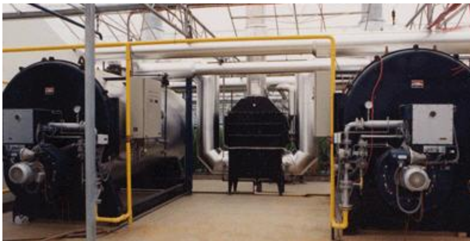
Εικόνα 5.23 Φωτογραφία από λεβητοστάσιο με δυο λέβητες
