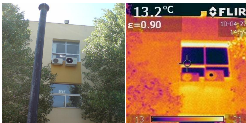
Εικόνα 5.11 Φωτογραφία του ανατολικού τοιχίου του κτιρίου και αντίστοιχη λήψη στο υπέρυθρο φάσμα.
