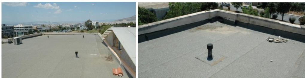
Εικόνα 5.23 Μόνωση δώματος με πισσόχαρτο και εμφανή σημάδια φθοράς
