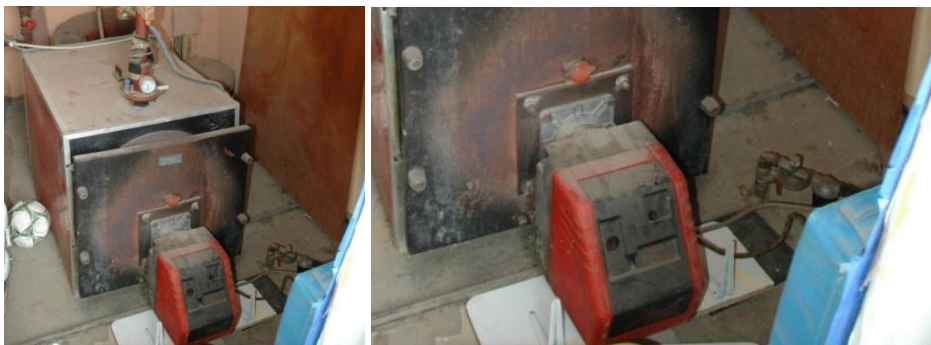
Εικόνα 5.15 Κακή κατάσταση και κακή συντήρηση λέβητα και καυστήρα
