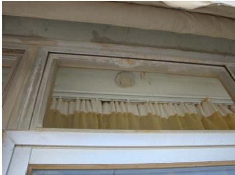
Εικόνα 5.13 Ανυπαρξία μόνωσης της ταράτσας
