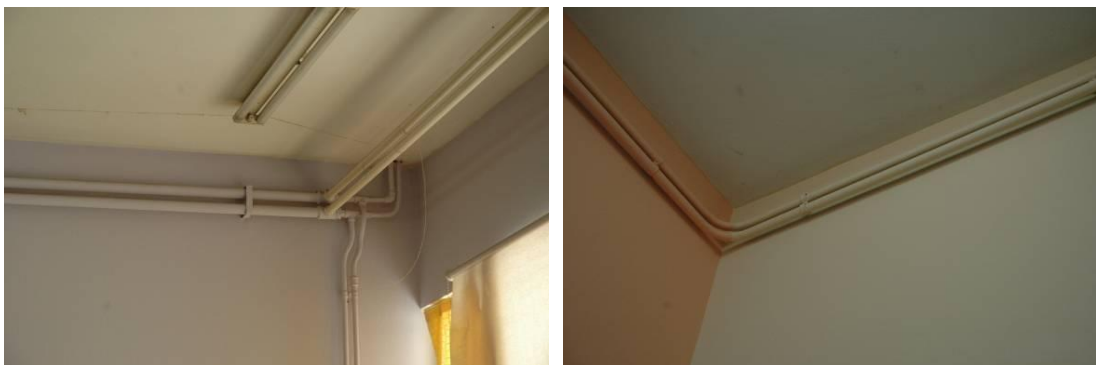
Εικόνα 5.20 Αμόνωτες σωληνώσεις του δικτύου θέρμανσης.
