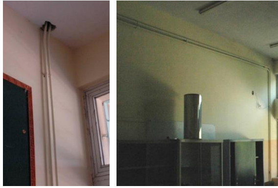
Εικόνα 5.29 Αμόνωντες σωληνώσεις του δικτύου θέρμανσης.
