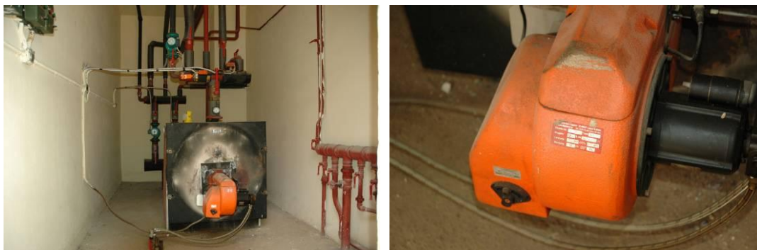
Εικόνα 5.6 Λέβητας και καυστήρας του εξεταζόμενου κτιρίου
