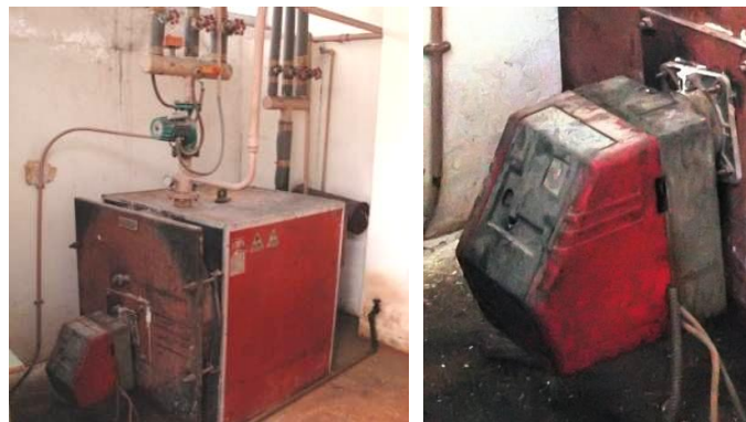
Εικόνα 5.28 Κακή κατάσταση και κακή συντήρηση λέβητα και καυστήρα
