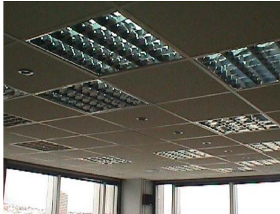
Εικόνα 4.3 Φωτιστικά σώματα σε τυπικό χώρο γραφείου [21]
