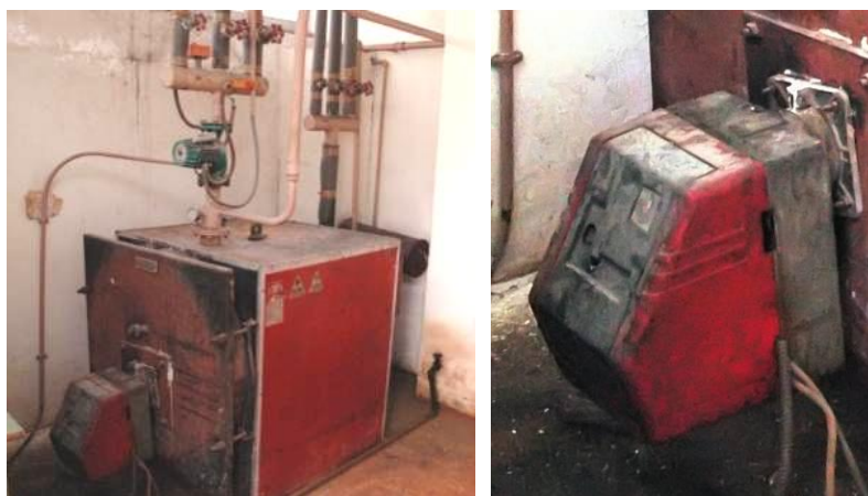
Εικόνα 5.7 Λέβητας και καυστήρας του εξεταζόμενου κτιρίου
