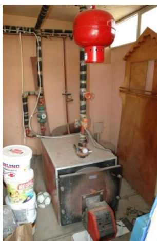
Εικόνα 5.5 Λέβητας και καυστήρας του εξεταζόμενου κτιρίου
