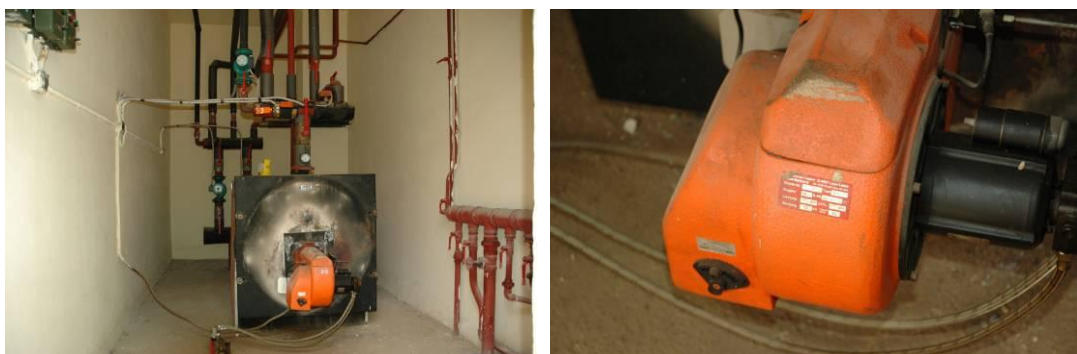
Εικόνα 5.19 Κακή κατάσταση και κακή συντήρηση λέβητα και καυστήρα
