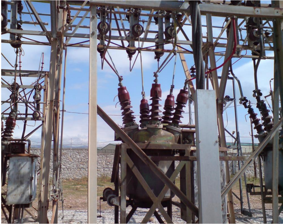
Εικόνα 3.35: Φωτογραφία του διακόπτη ελαίου που μελετήθηκε θερμικά
