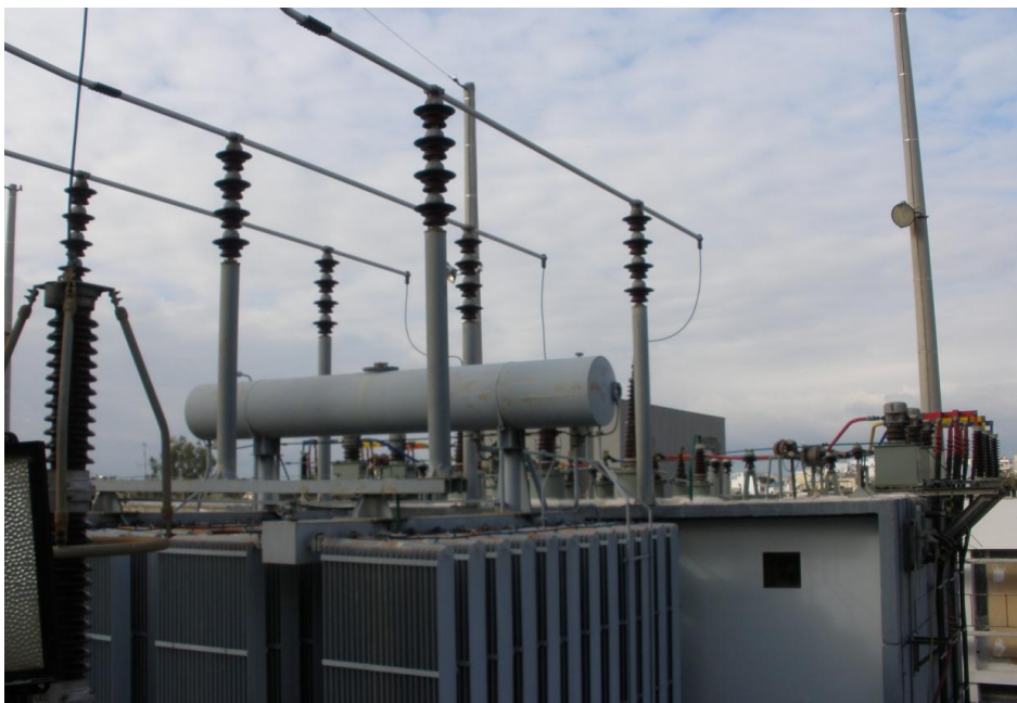
Εικόνα 3.13: Φωτογραφία του μετασχηματιστή που μελετήθηκε θερμικά
