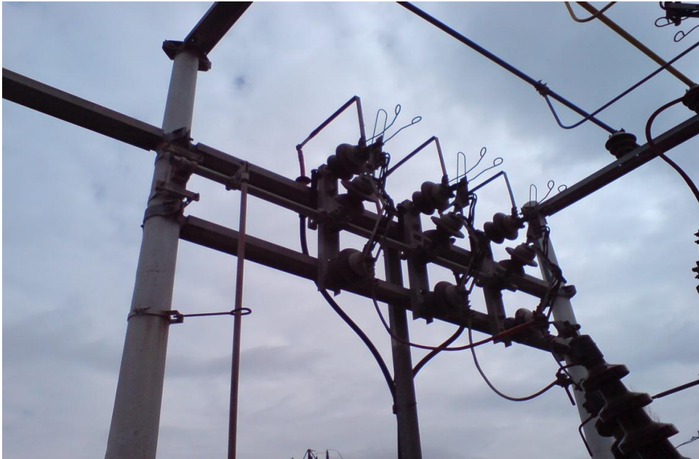
Εικόνα 3.31: Φωτογραφία του συστήματος αποζευκτών που μελετήθηκε θερμικά
