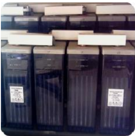
Εικόνα 2.5 : Συσσωρευτές εργαστηρίου ΣΗΕ
