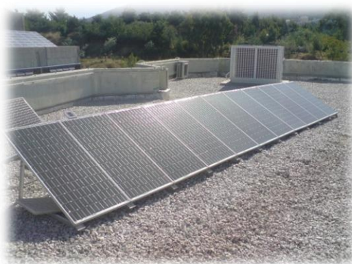
Εικόνα 2.3: Φωτοβολταϊκά πλαίσια εργαστηρίου ΣΗΕ
