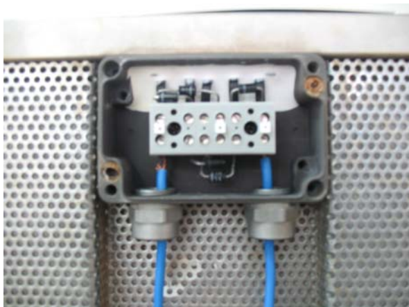
Εικόνα 21 : Παρακαμπτήριες διόδους φωτοβολταϊκού πλαισίου
